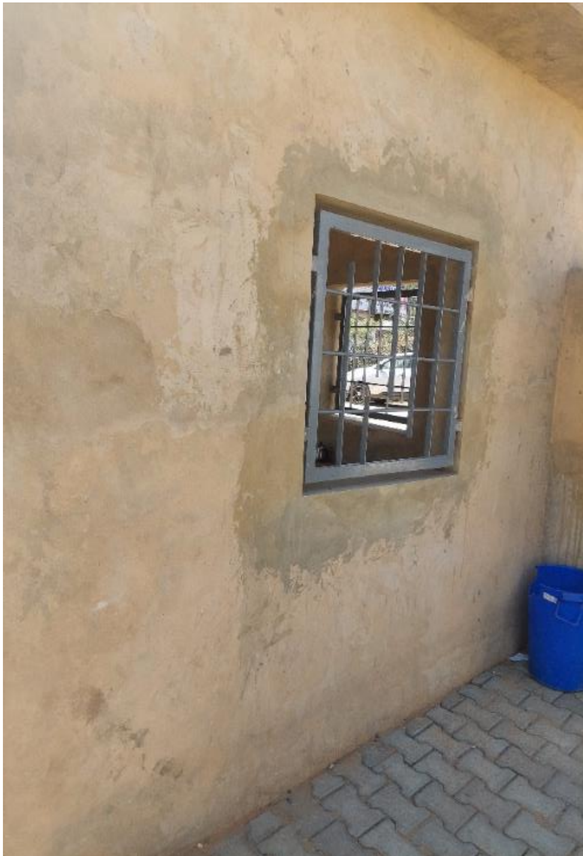
Image 10 : Non mise en œuvre des travaux de second-œuvre : guérite
