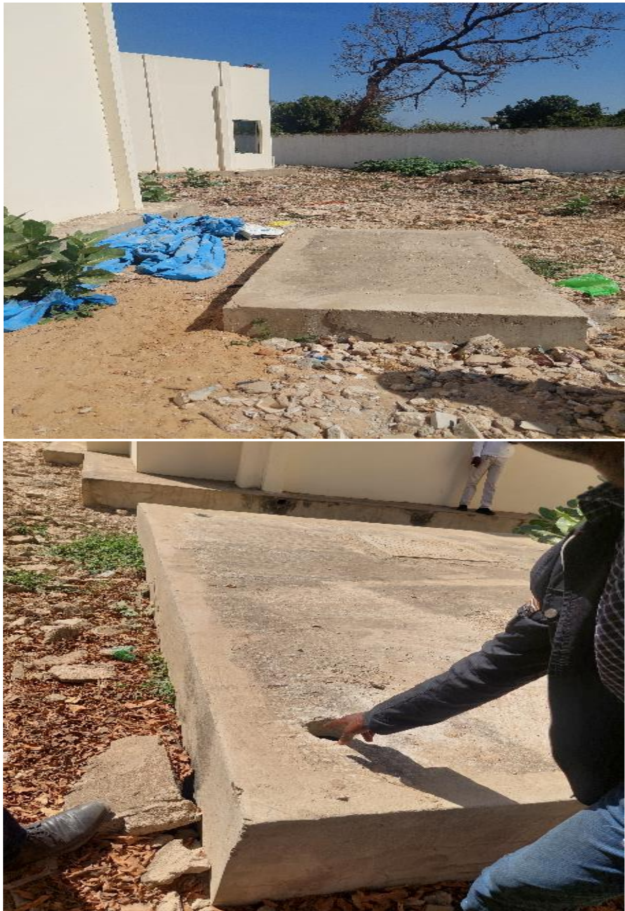
Image 11 : Absence de tuyaux d'aération des fosses
