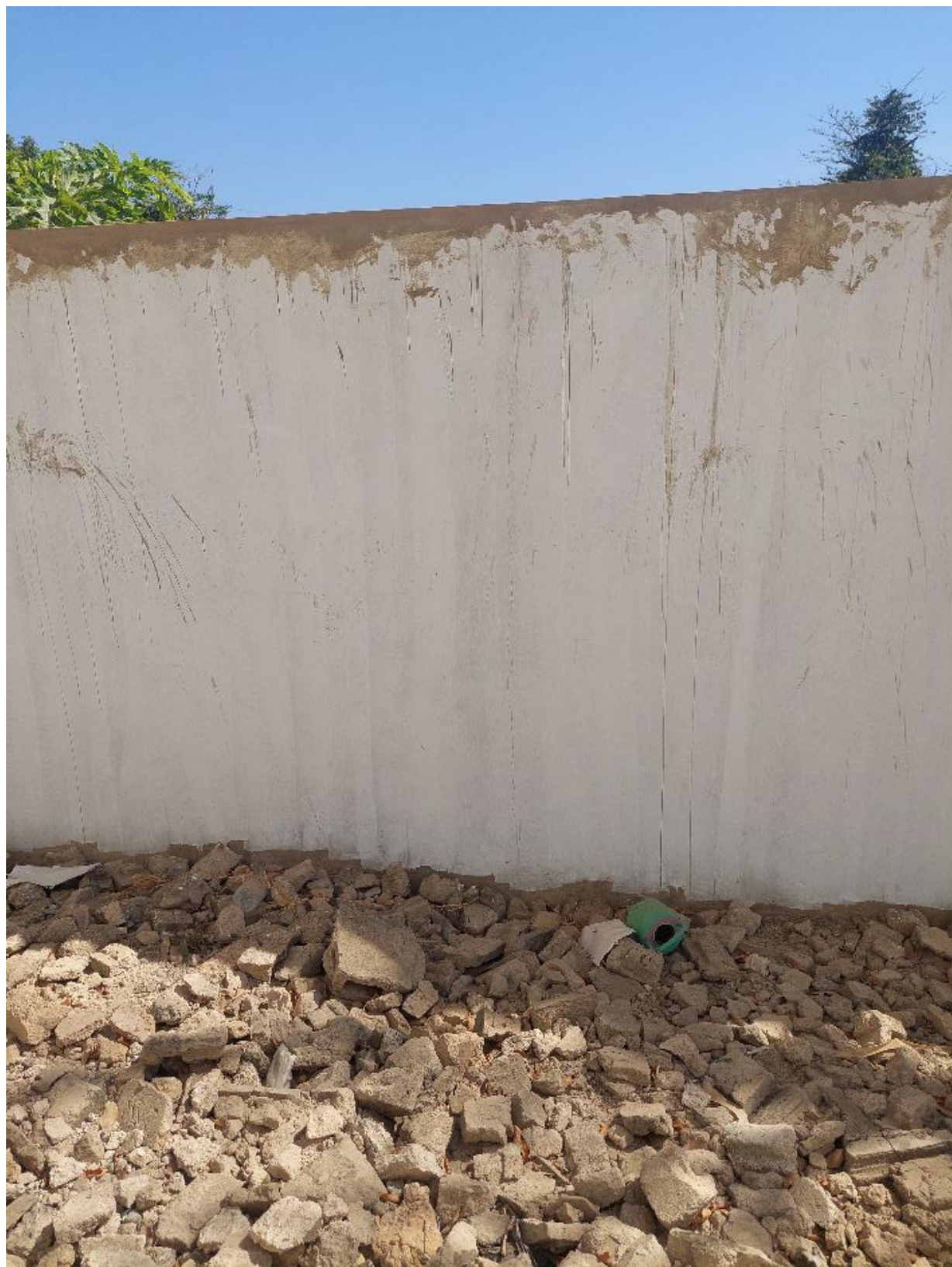
Image 3 : Absence de joint de dilatation sur le mur de clôture
