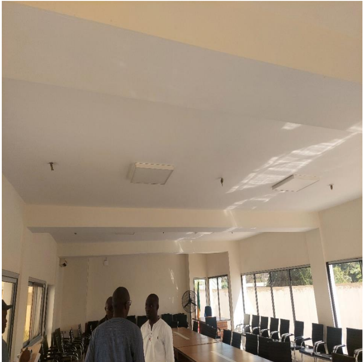
Image 9 : Absence des brasseurs d'air dans la salle de réunion
