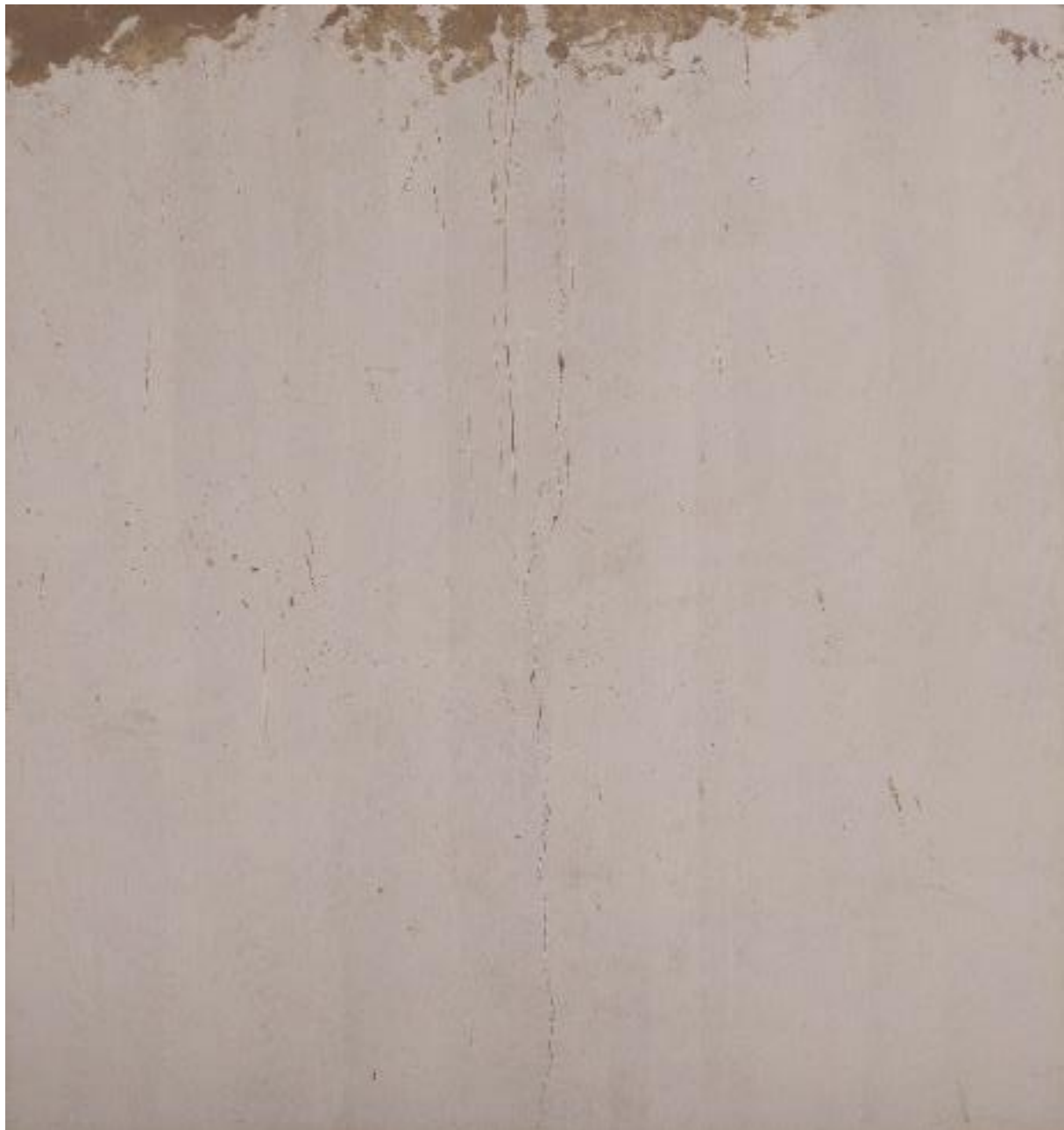
Image 2 : Fissures sur le mur de clôture
