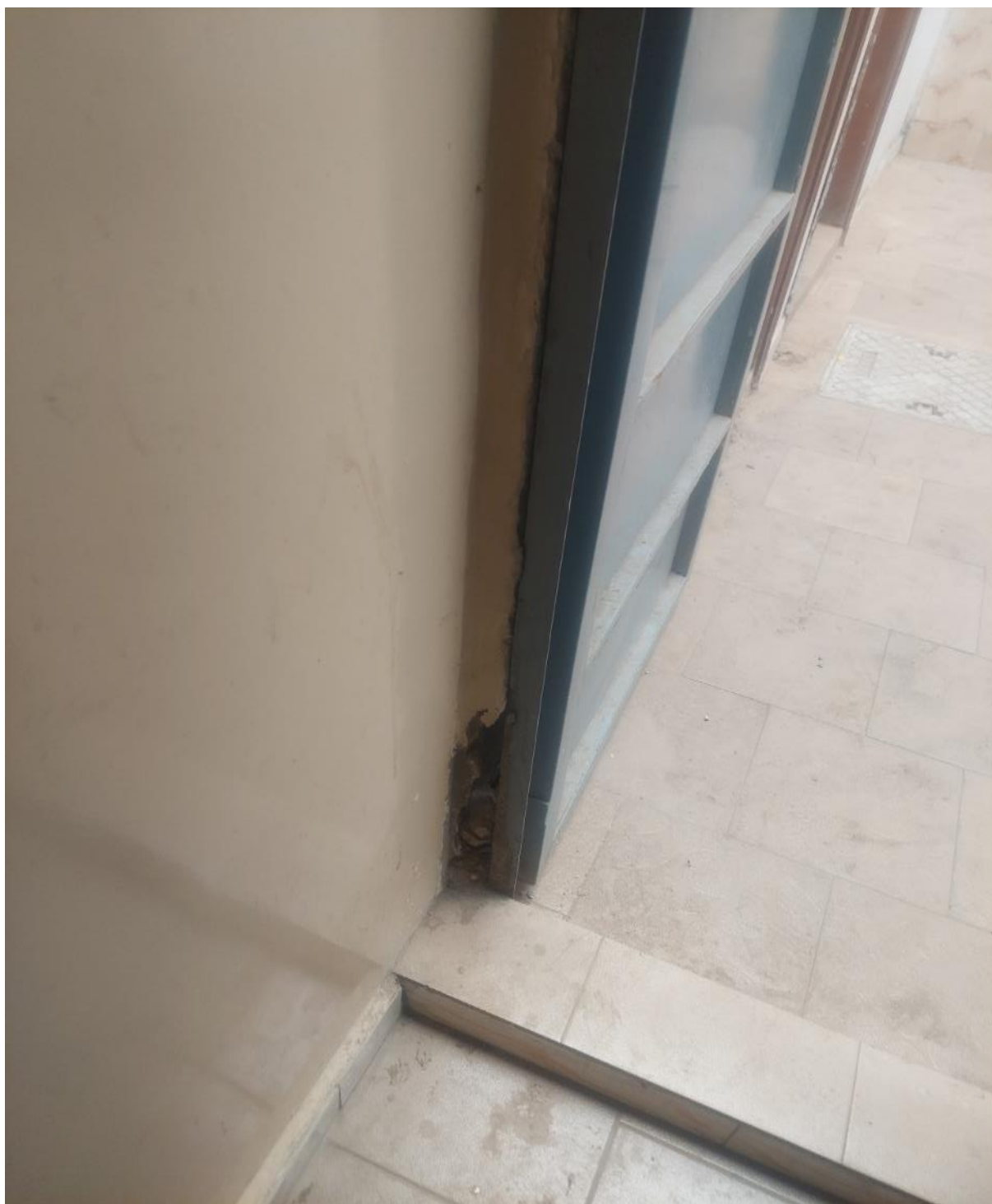
Image 1 : Absence de deux (02) marches à l'entrée de l'auditorium
