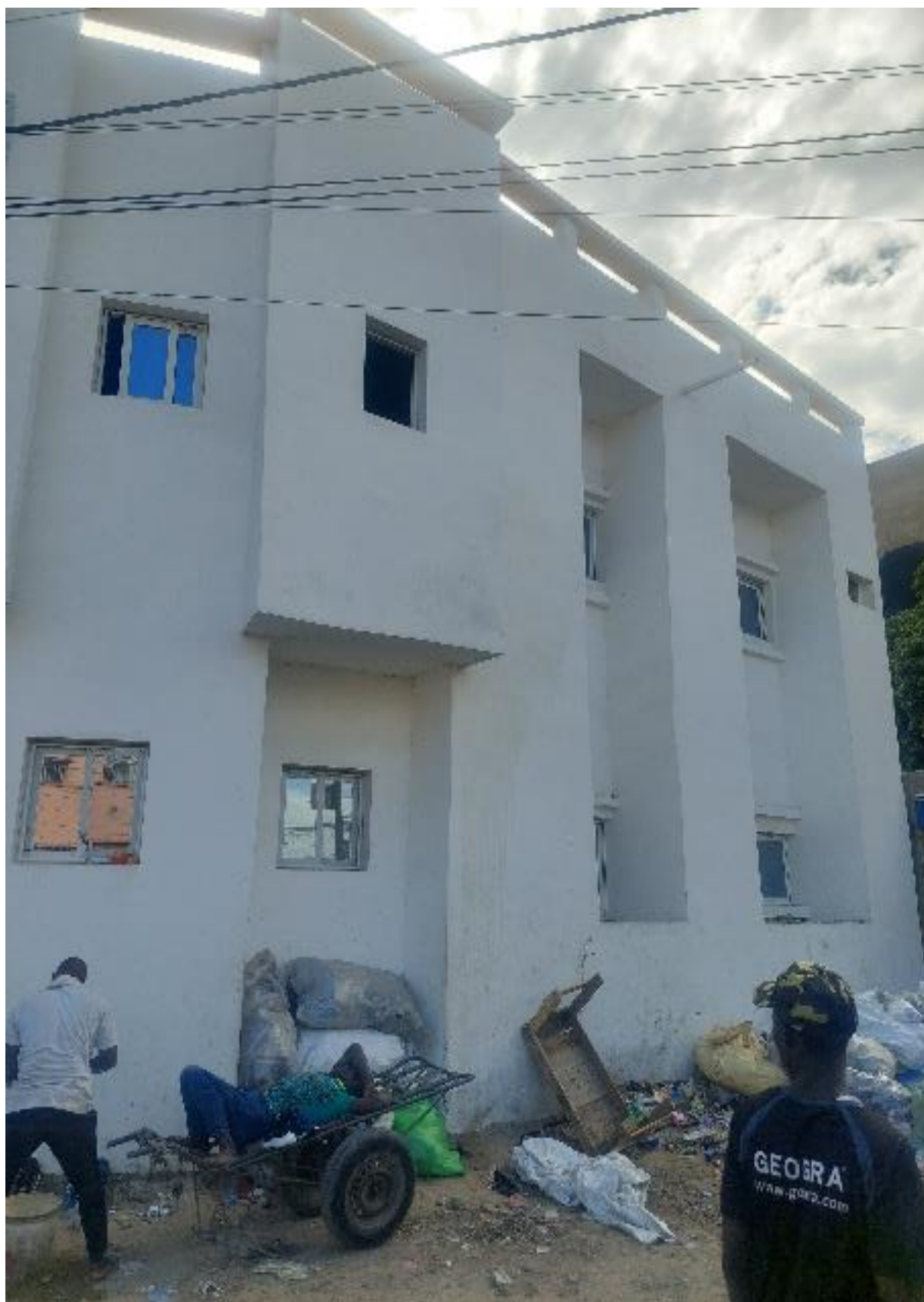
Image 9 : Non pose des carreaux pour la façade
