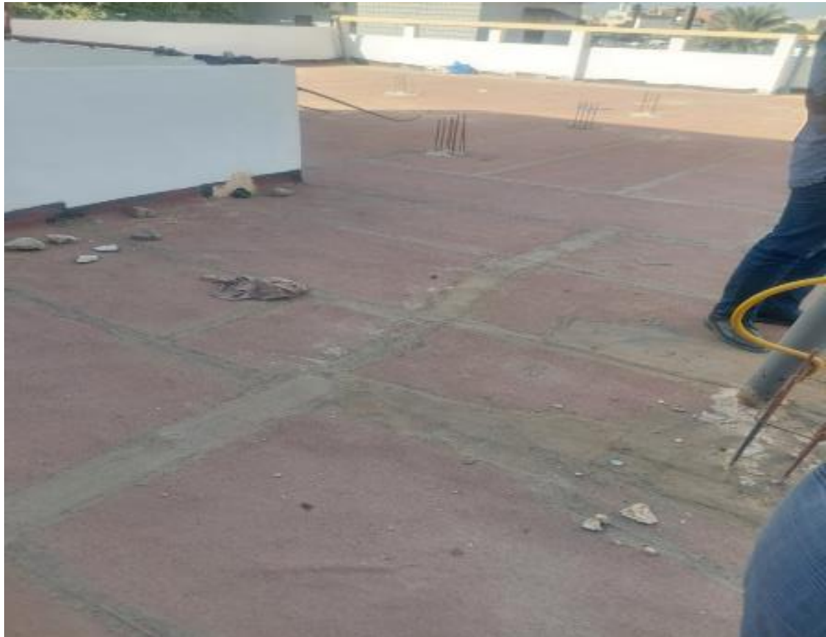
Image 8 : Non pose de carreaux sur la terrasse accessible
