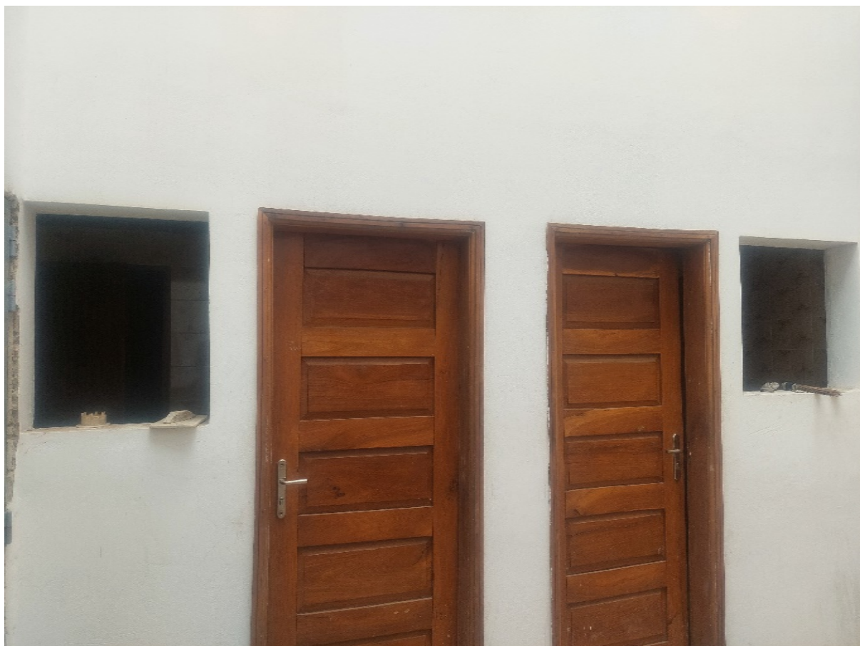
Image 2 : Absence de fenêtres au niveau du rez de chaussée
