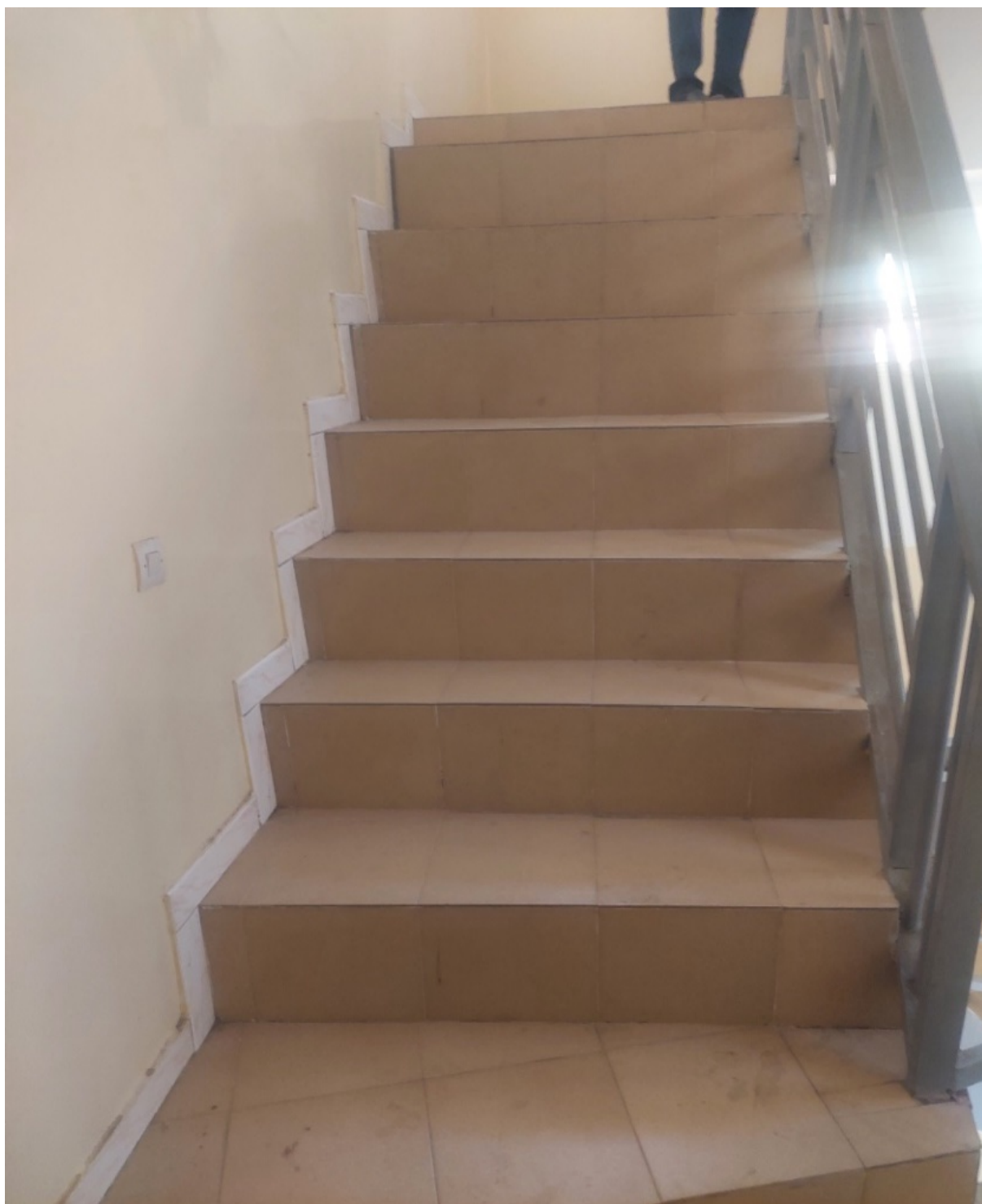
Image 6 : Hauteur non conventionnelle des escaliers
