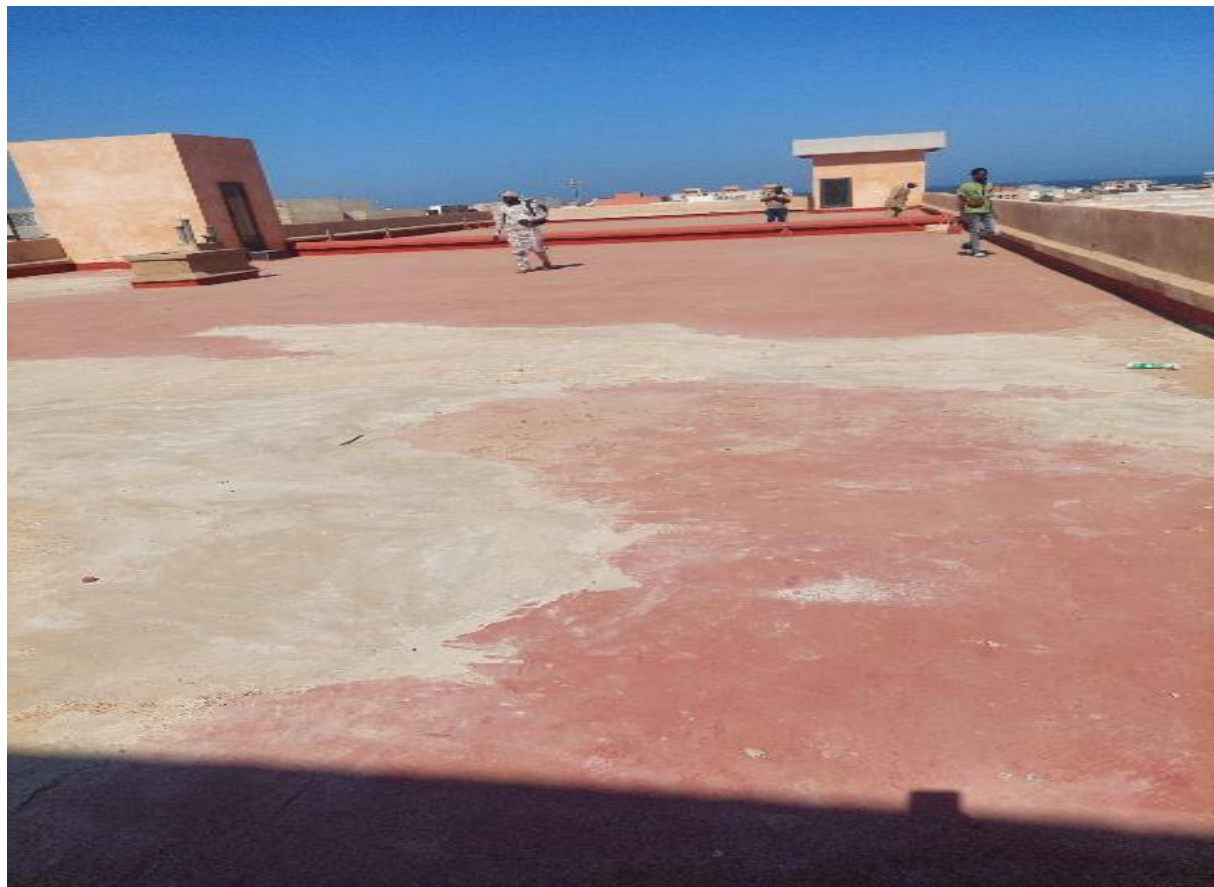
Image 16 : Trace de stagnation d'eau au niveau de la terrasse
