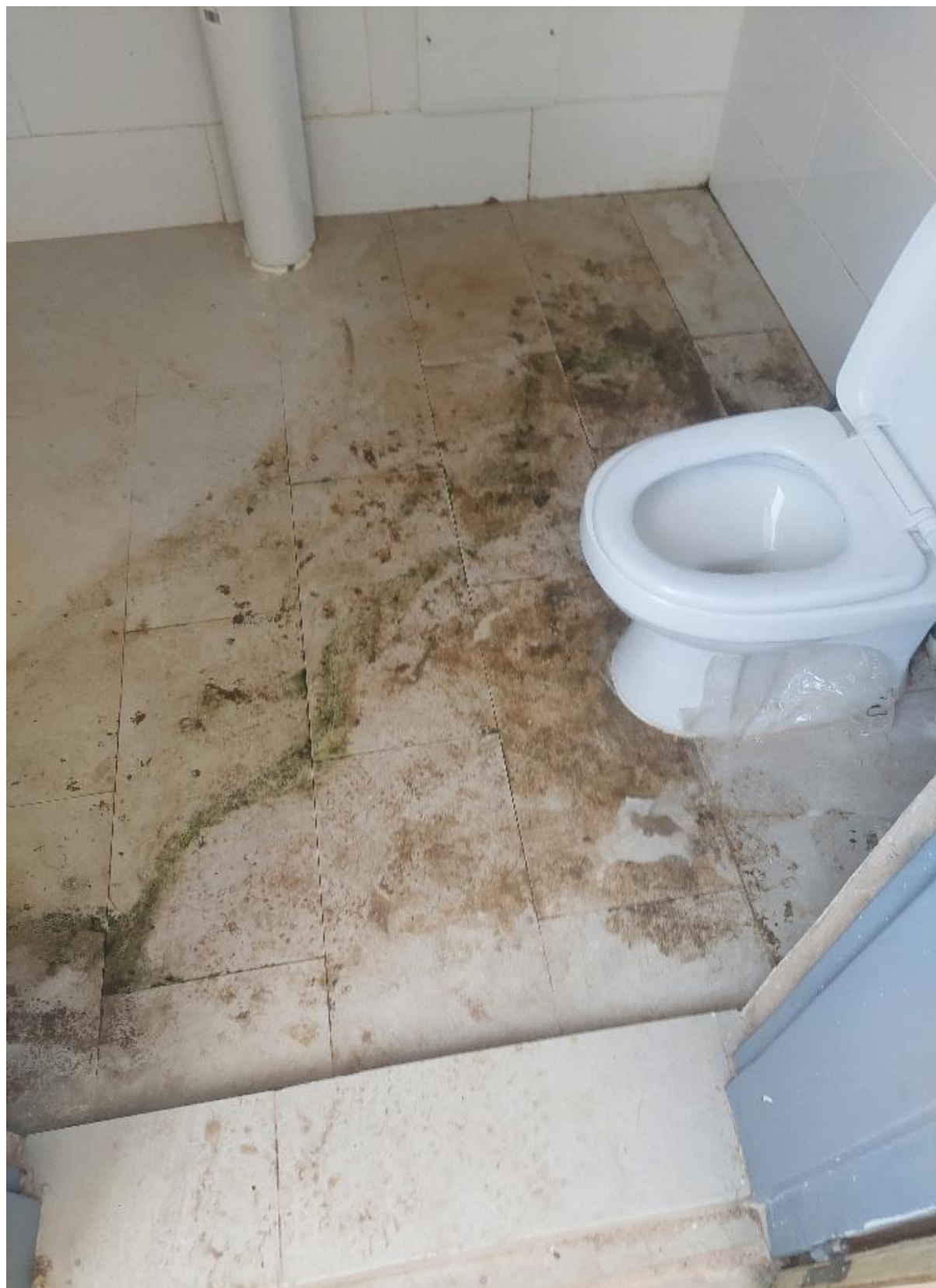
Image 12 : Stagnation d'eau dans la toilette du bureau du chef de service
