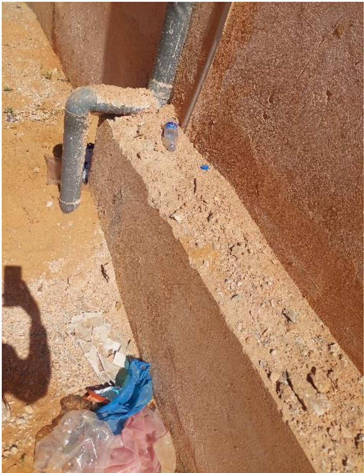
Image 15 : Non protection de la descente de PVC à l'arrière de l'ouvrage
