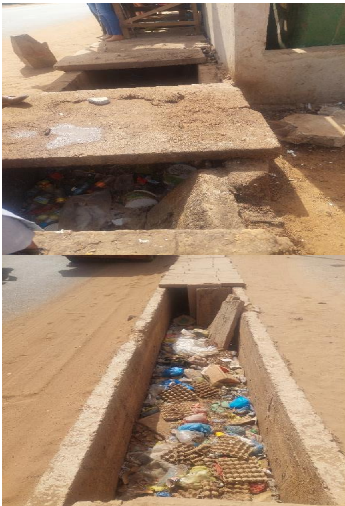
Image 2 : Absence de dalles
