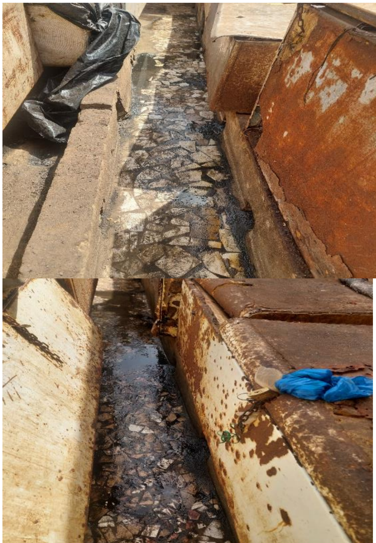
Image 1 : Pente mal réalisée
