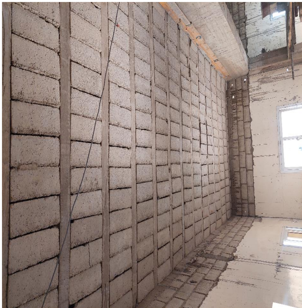
Image 1 : Non-conformité entre les réalisations et les plans archis à propos des poutres
