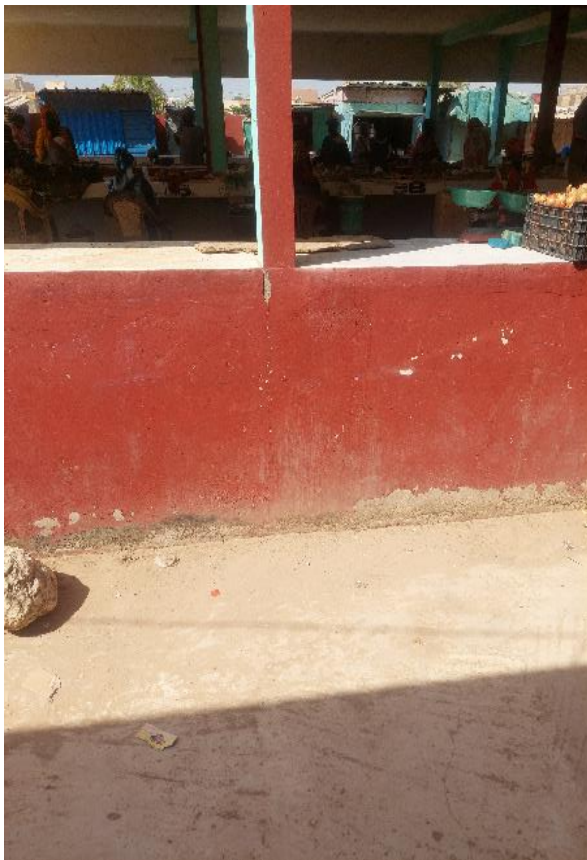
Image 3 : Apparition de fissures sur les murs
