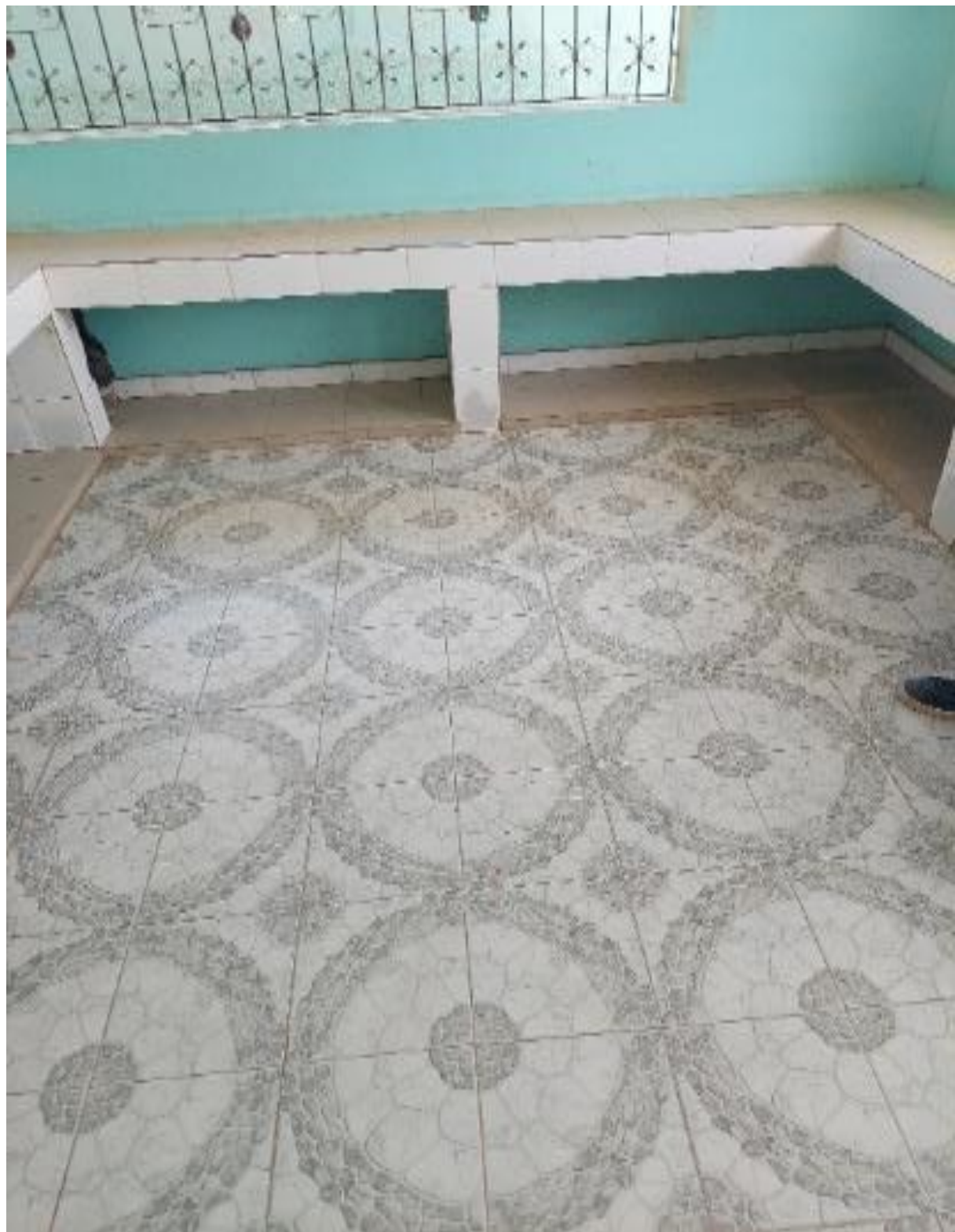
Image 4 : Hauteur non conventionnelle des bancs au niveau de l'accueil
