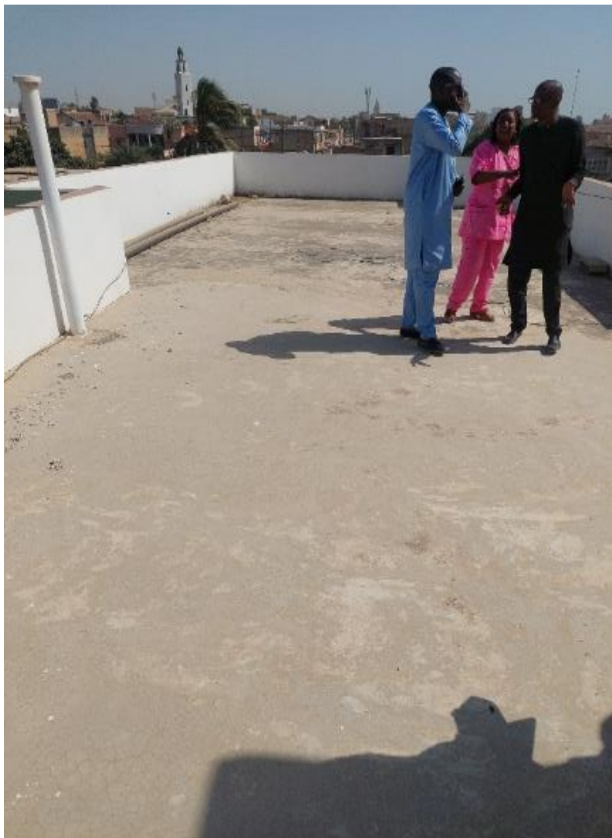
Image 2 : Non pose de l'étanchéité
