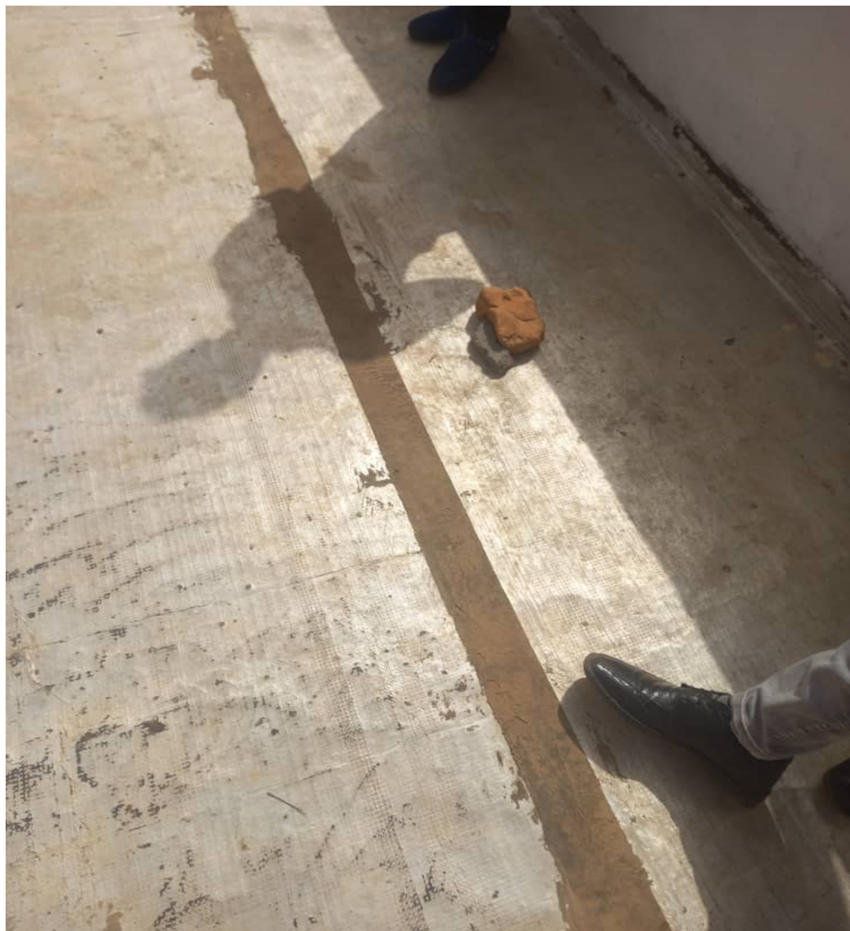
Image 15 : École Sébi Thiokho : Relevé d'étanchéité non conforme
