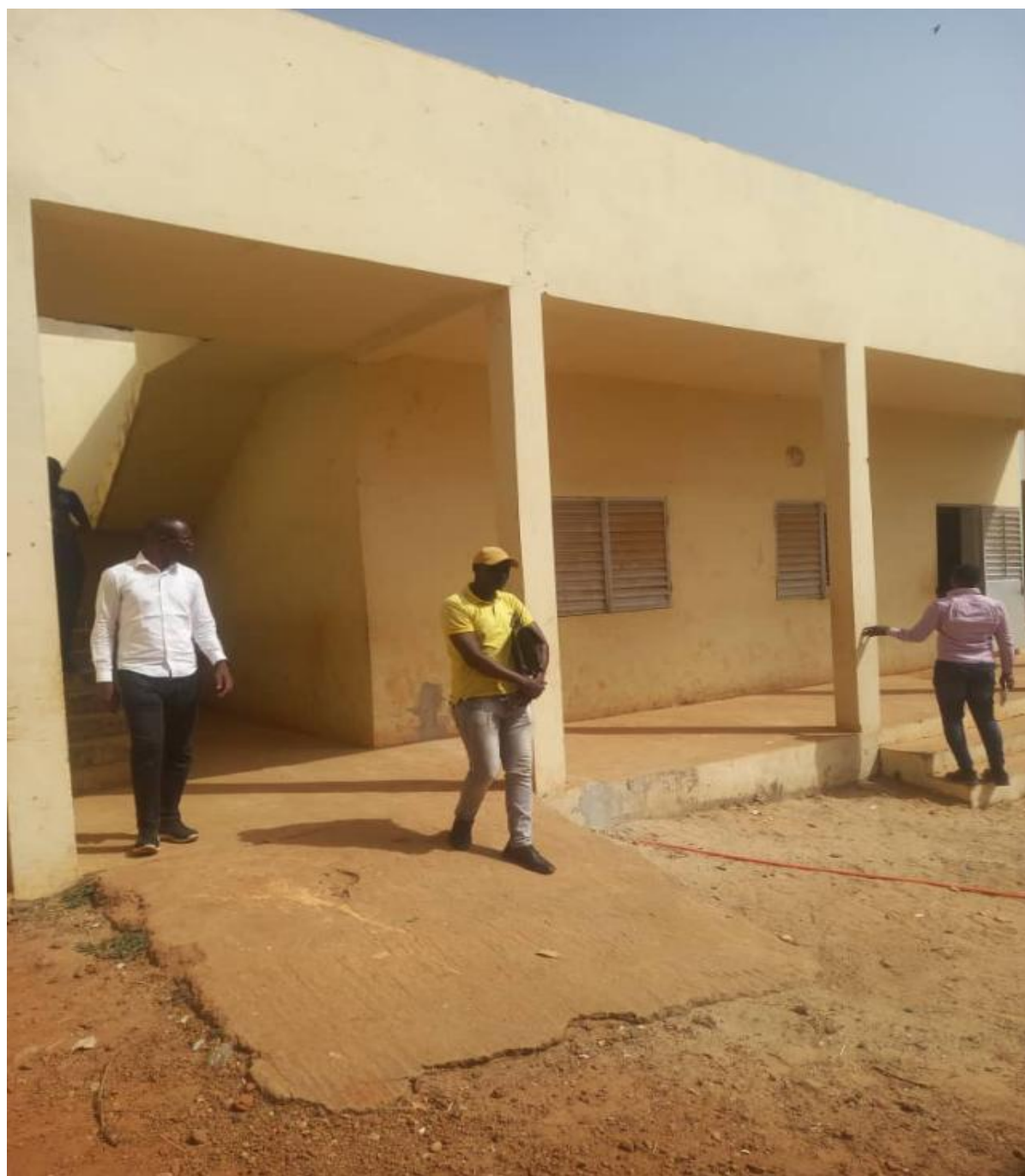
Image 16 : École Sébi Thiokho : Faiblesse de l'épaisseur de dalle au sol de la véranda
