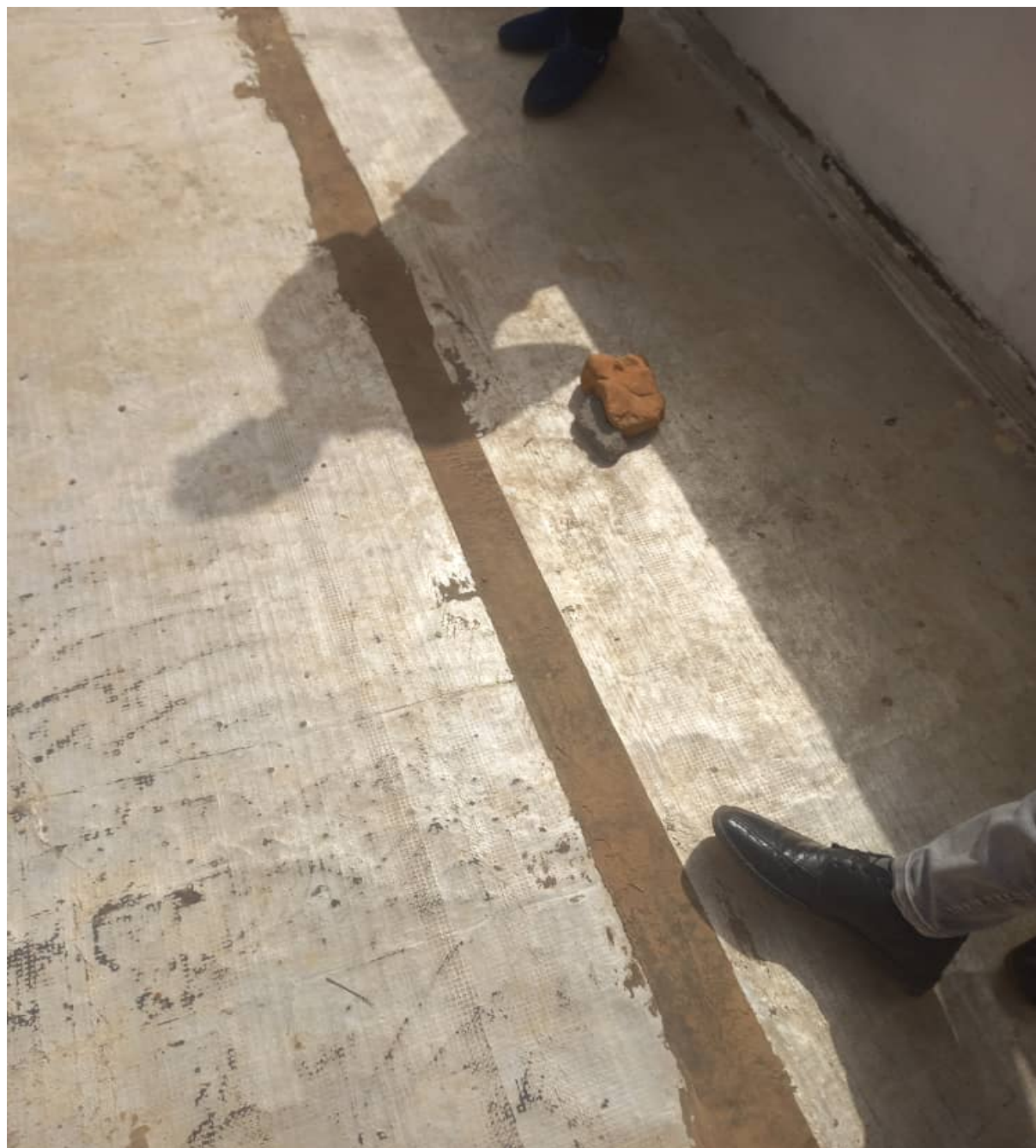
Image 14 : École Sébi Thiokho : Stagnation de l'eau (traces) au niveau de la terrasse
