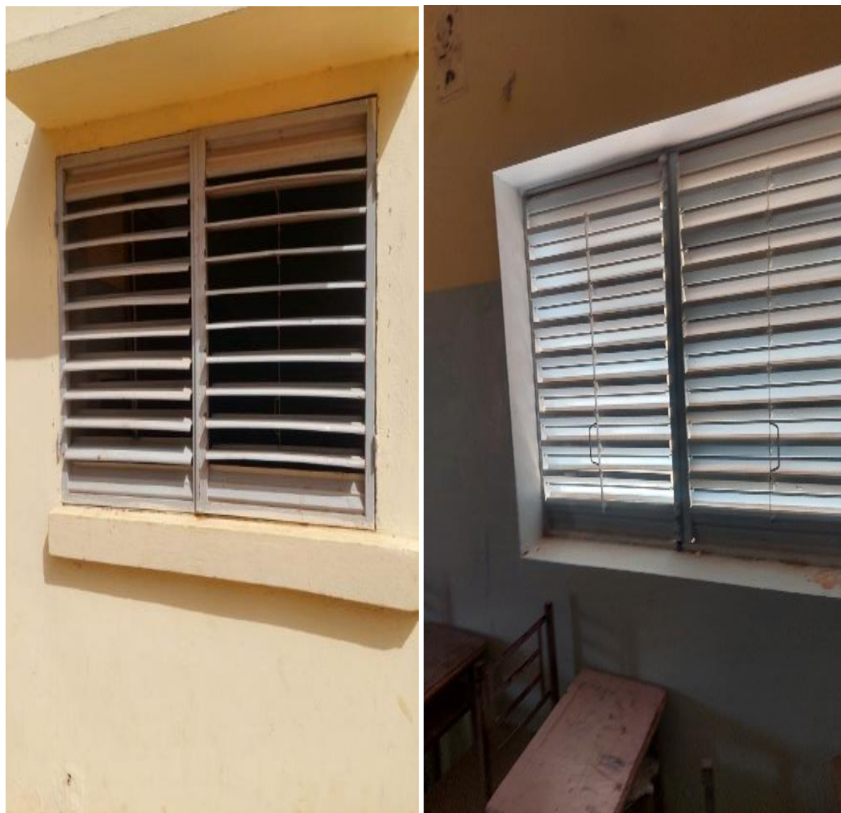
Image 12 : École Sébi Thiokho : Problème de fermeture des portes et fenêtres
