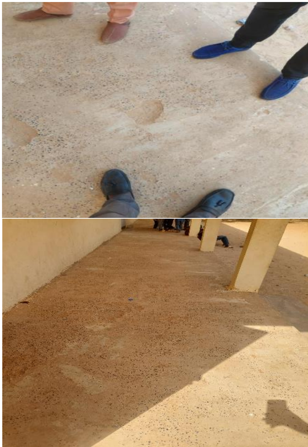
Image 4 : École Sébi Route II : Faiblesse de l'épaisseur de la dalle au sol de la véranda
