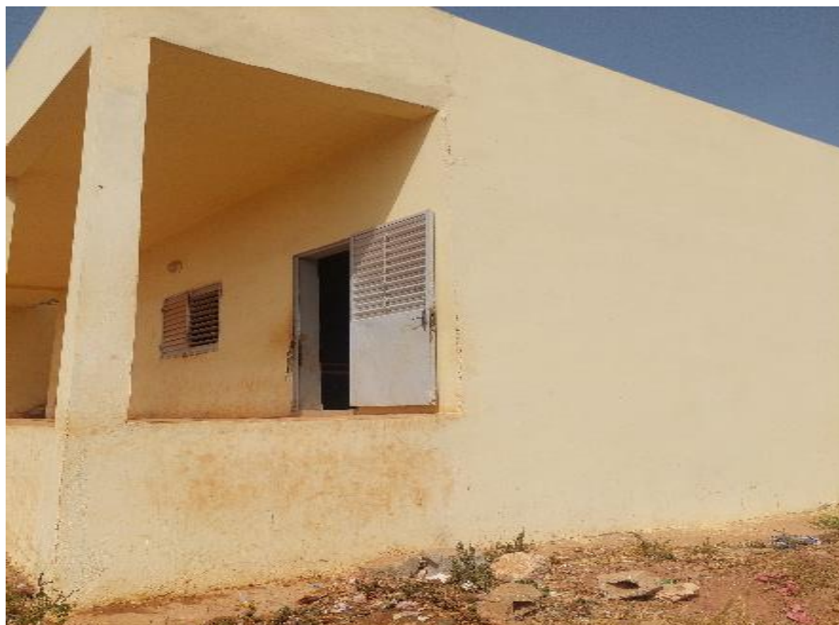
Image 17 : École Sébi Thiokho : Fondation haute : Absence d'une barrière
