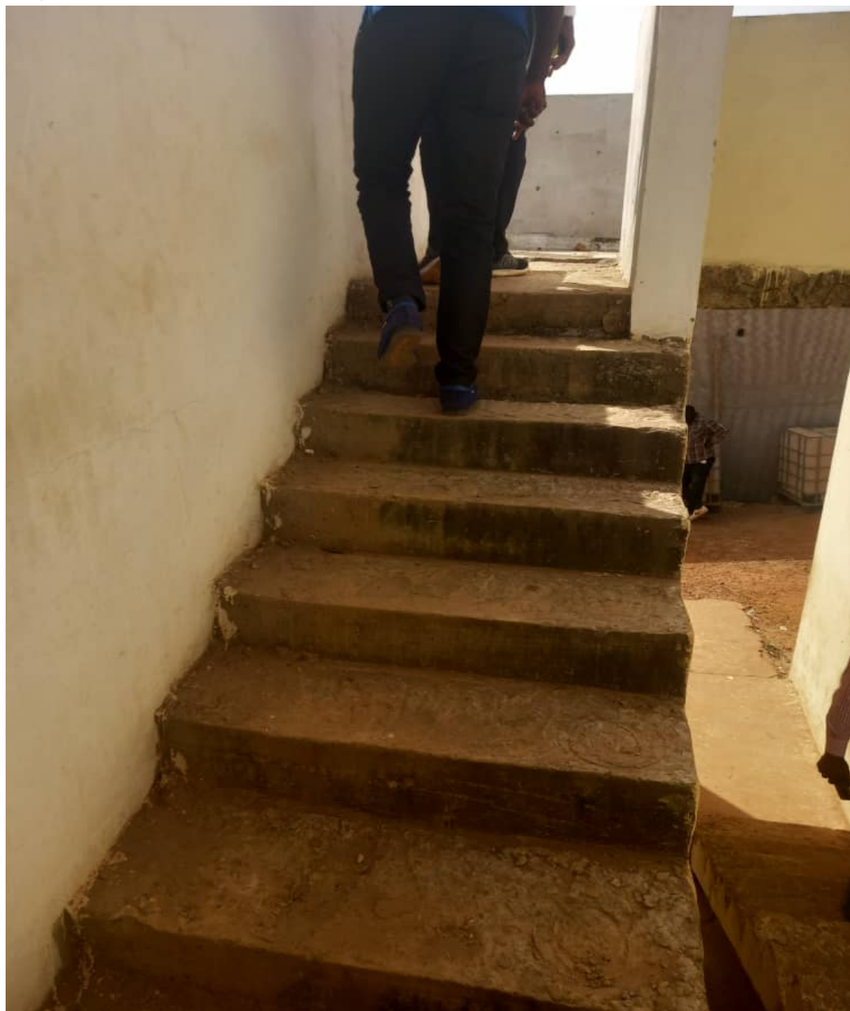
Image 13 : École Sébi Thiokho : Absence de la main courante au niveau de l'escalier
