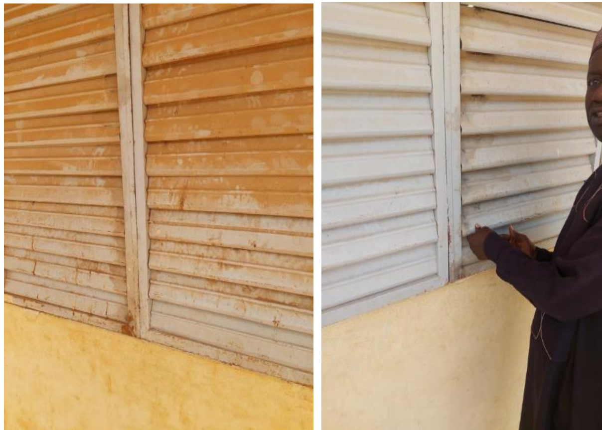
Image 3 : École Sébi Route II : Problème de fermeture des portes et fenêtres
