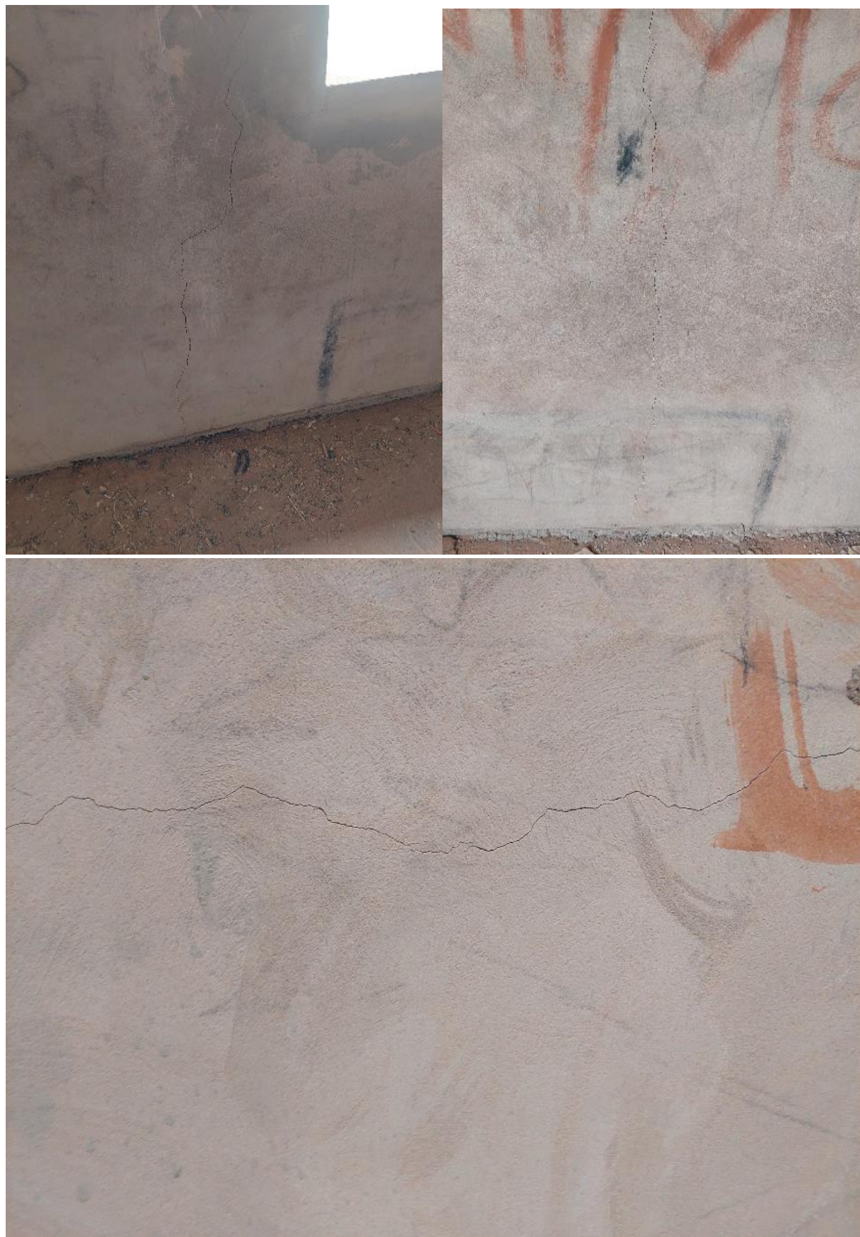
Image 7 : Fissures sur les murs et le sous plancher au niveau du bâtiment administratif
