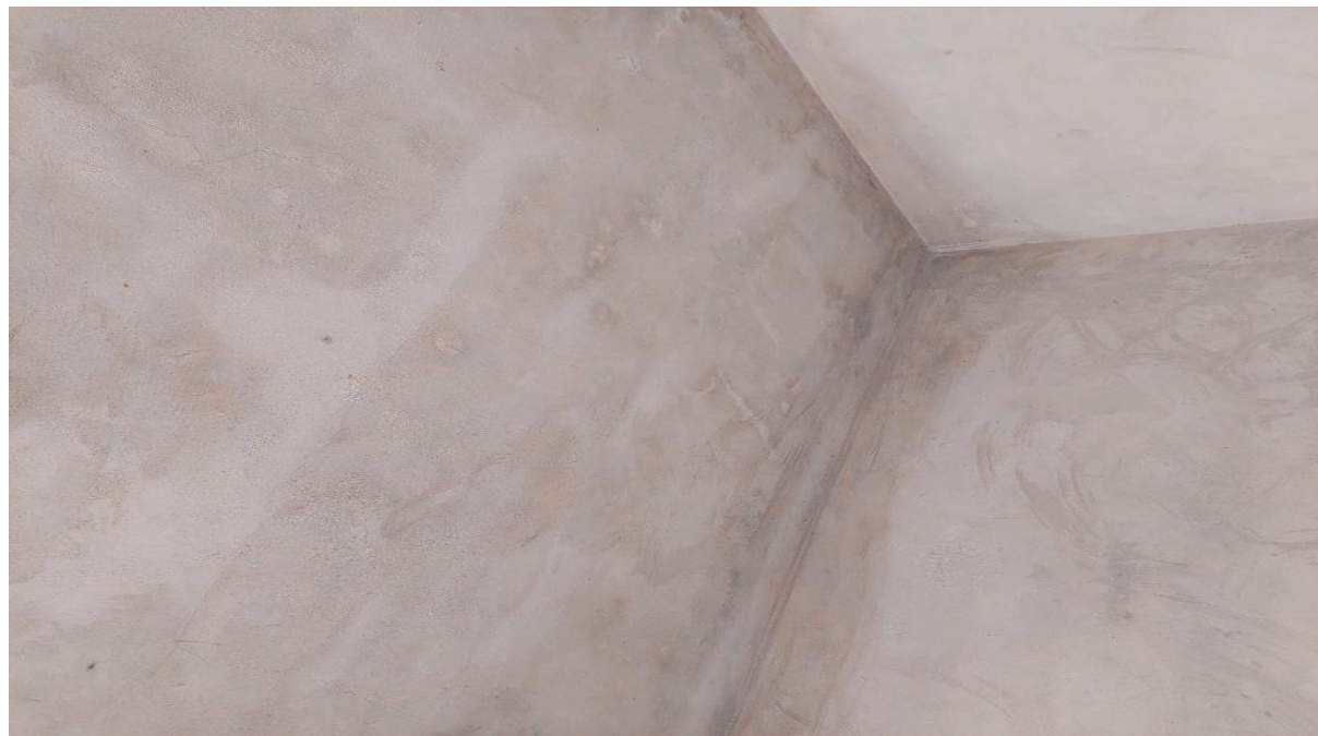
Image 6 : Présence de traces d'eau sous le plancher au niveau du bâtiment administratif
