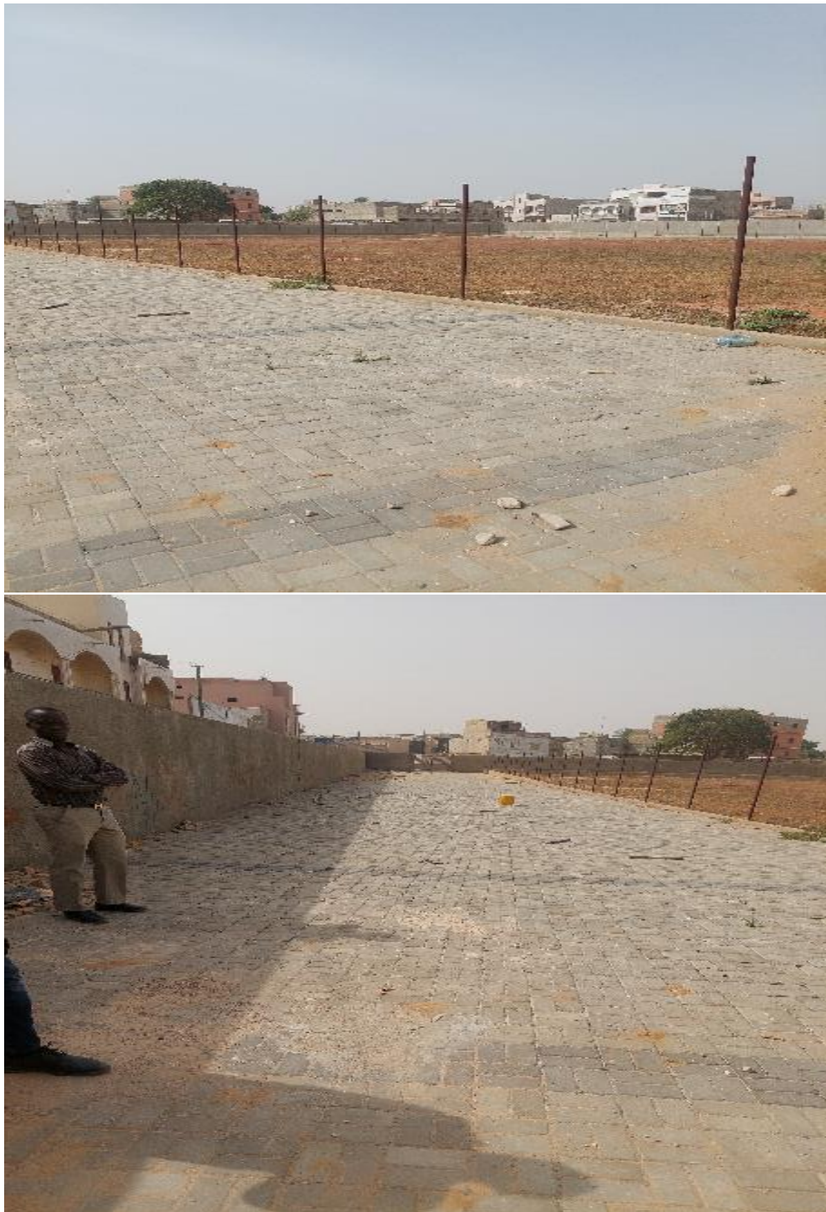
Image 4 : Affaissement par endroit de l'aménagement extérieur
