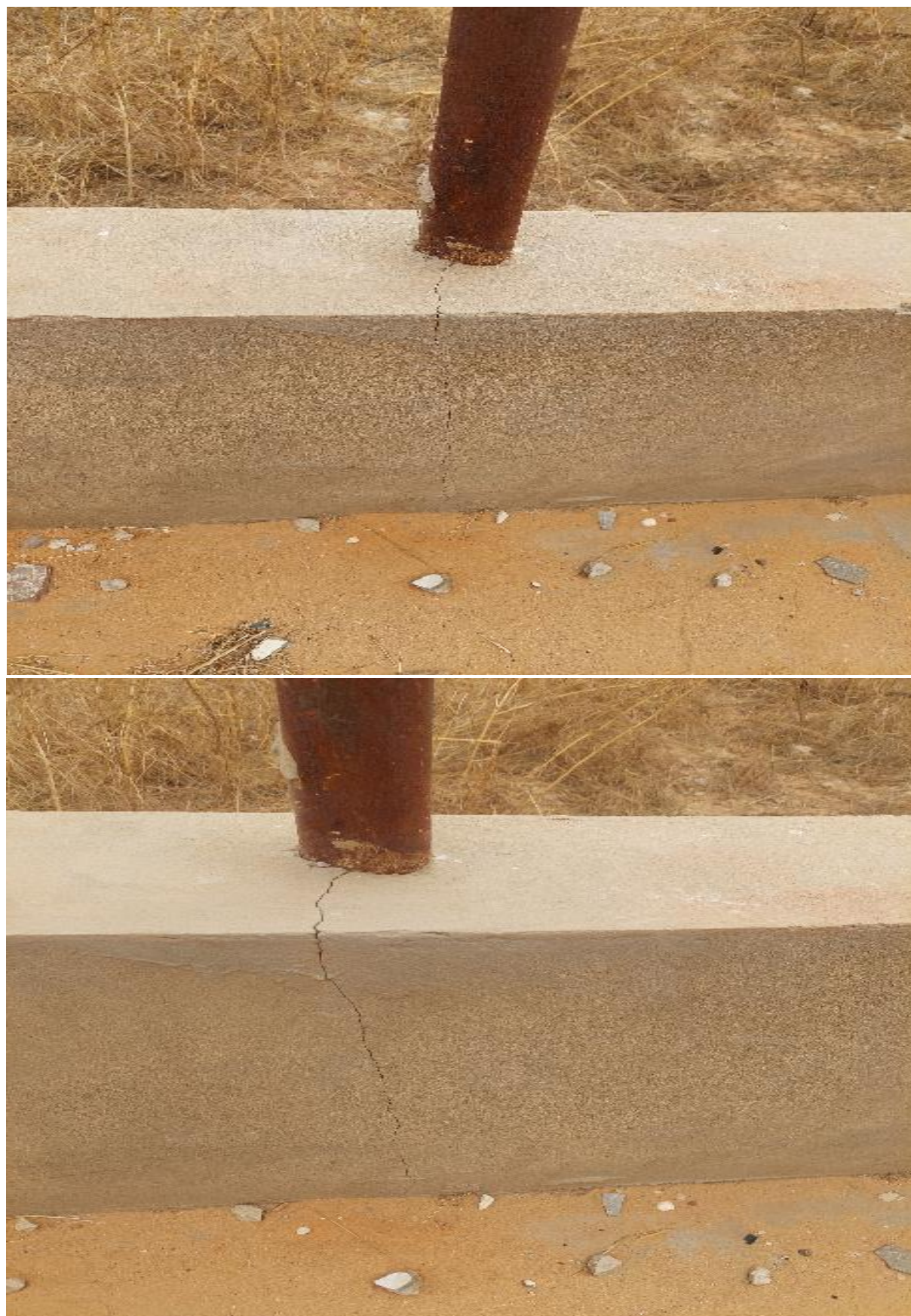
Image 3 : Apparition de fissures sur les poteaux
