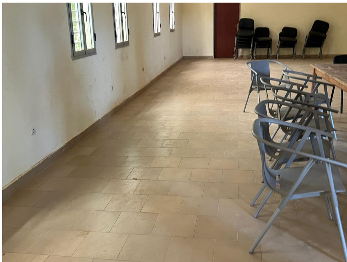
Image 3 : Problème de nivellement dans l'installation des carreaux
