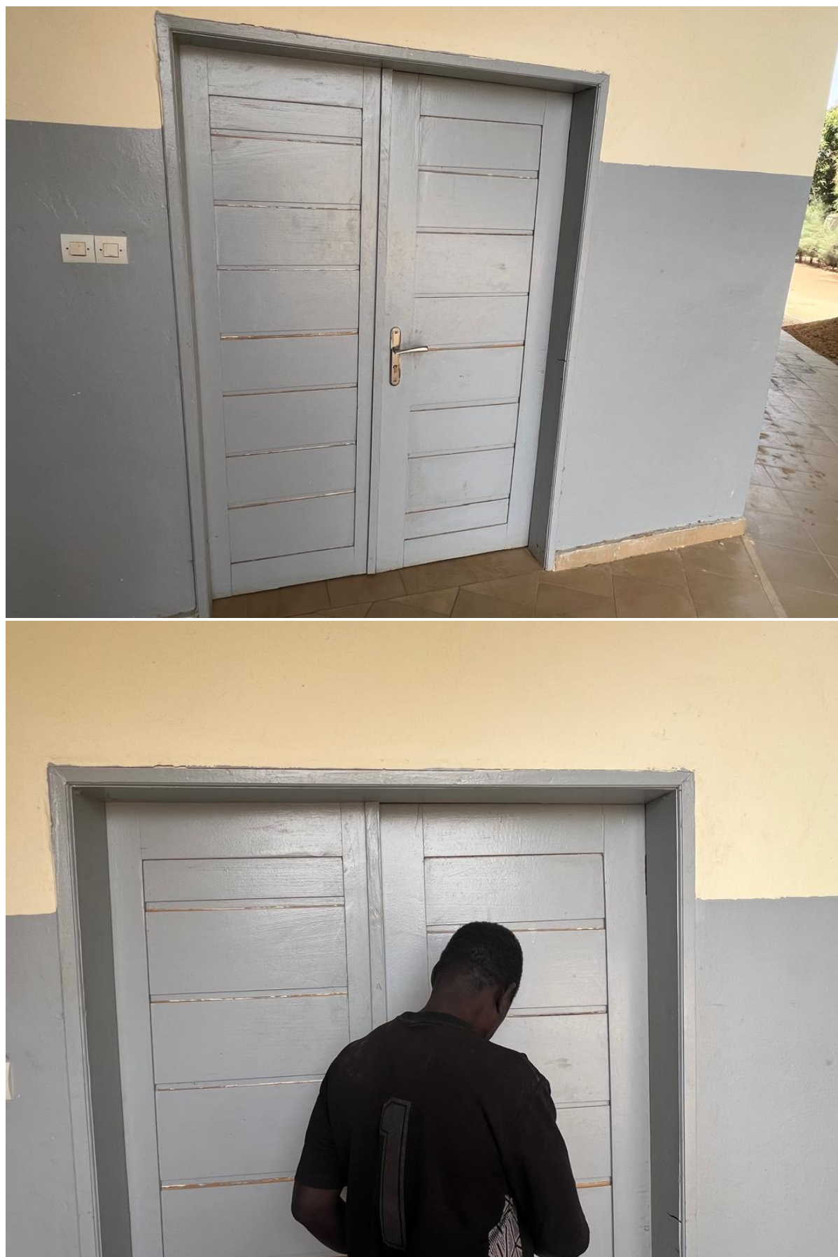
Image 4 : Absence de couvre joint sur certaines portes intérieures et extérieures
