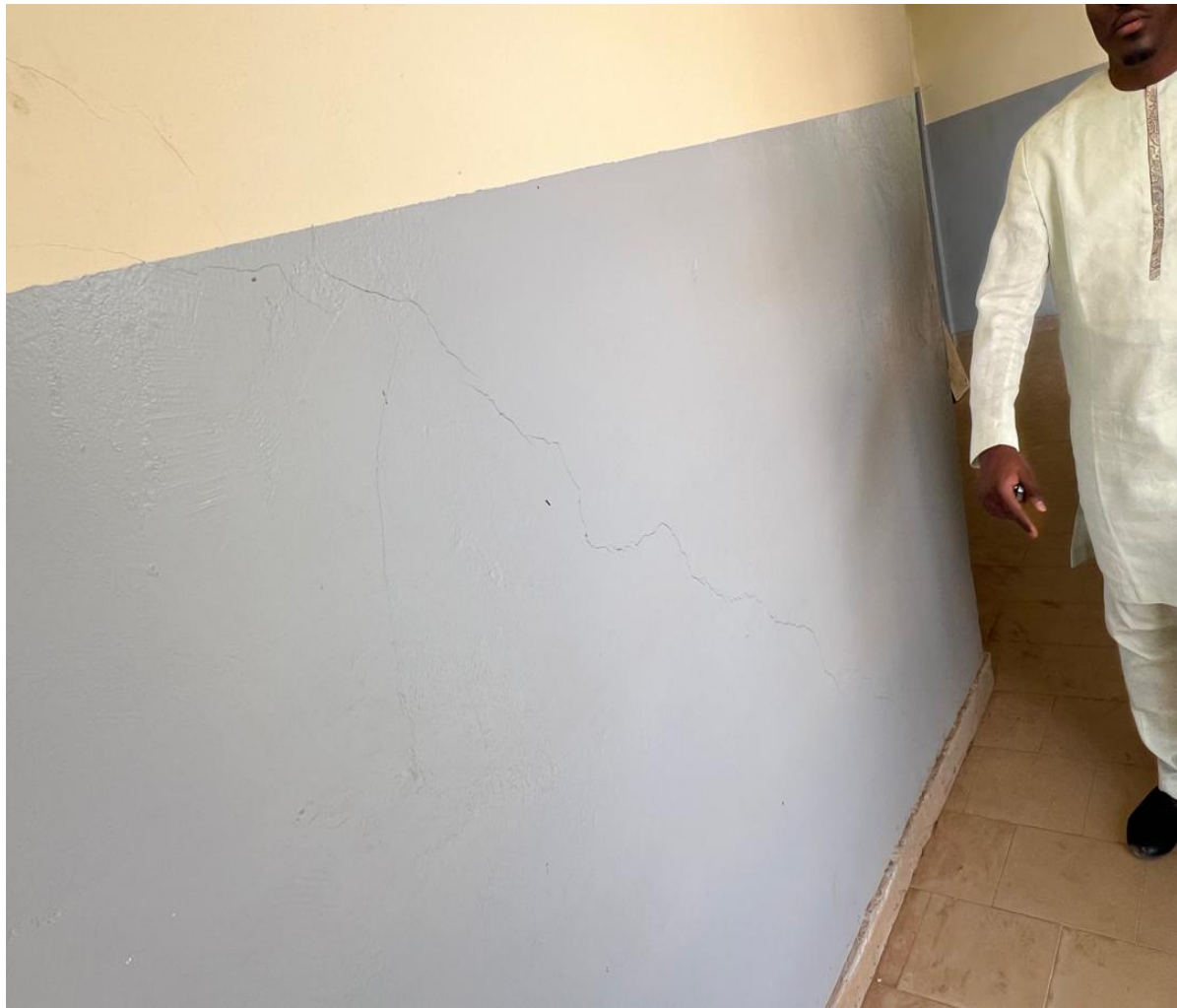
Image 2 : Apparition de fissures sur les murs, plans et retombées de poutres
