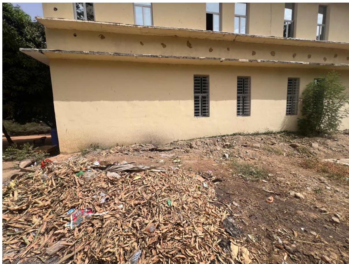
Image 8 : Absence de pente et de raccordement au niveau de l'auvent
