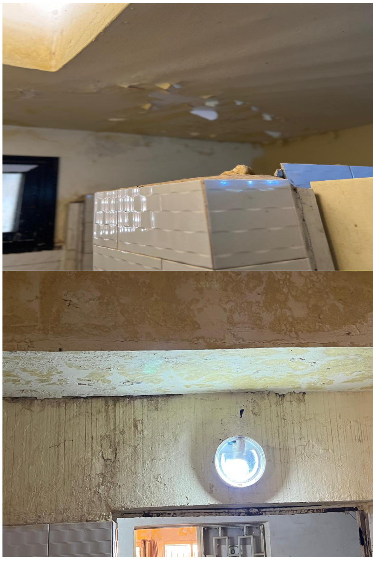
Image 9 : Présence de traces d'humidité sur les murs et faux plafonds
