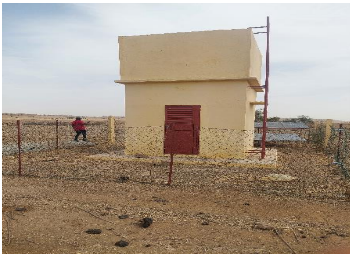
Image 7 : Traces d'humidité sur la cuve du château d'eau
