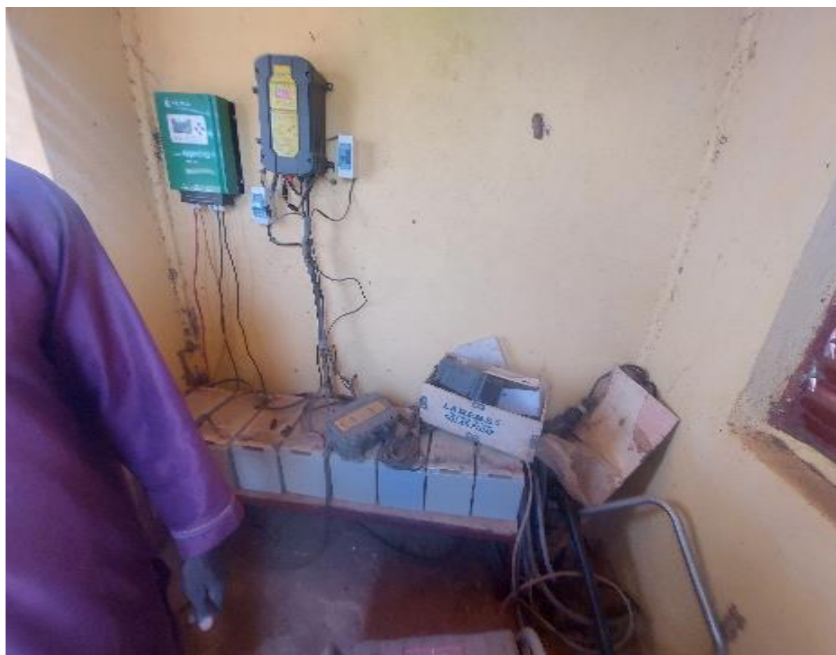
Image 9 : Défaillances des batteries solaires et du groupe électrogène
