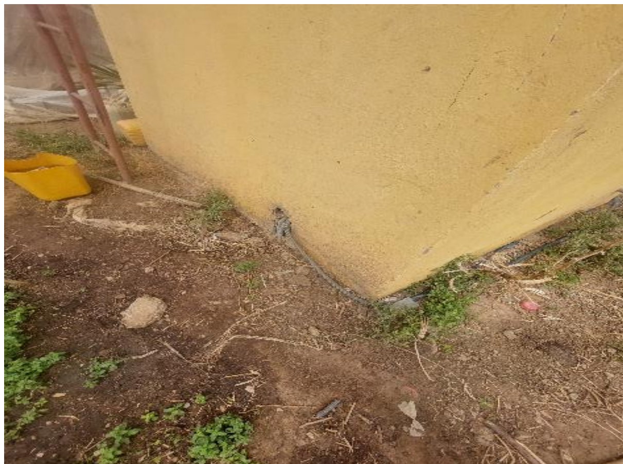
Image 6 : Absence de revers d'eau au niveau du château d'eau
