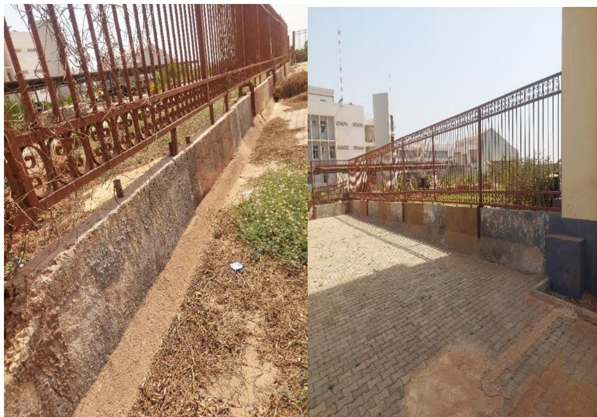
Image 5 : Peinture du mur de clôture lessivée
