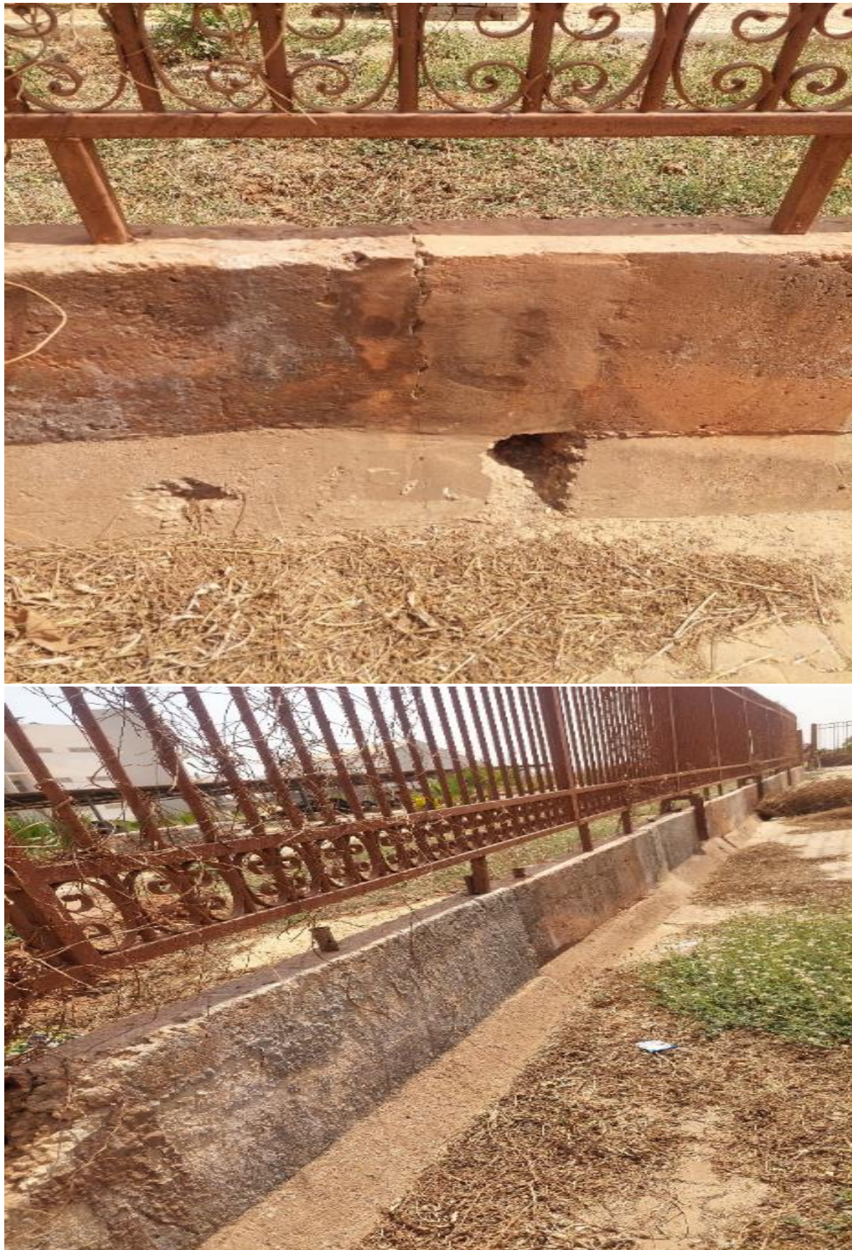
Image 3 : Fissures sur les murs de clôture
