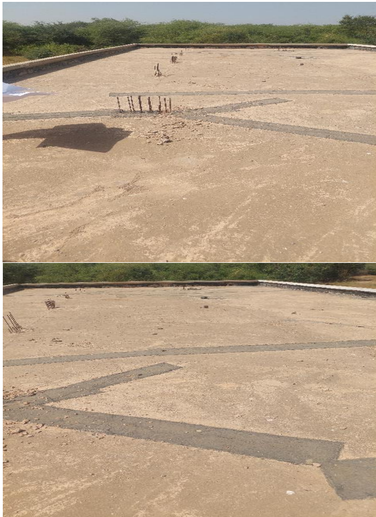
Image 4 : Bâtiment 1 x 5 : Absence d'étanchéité
