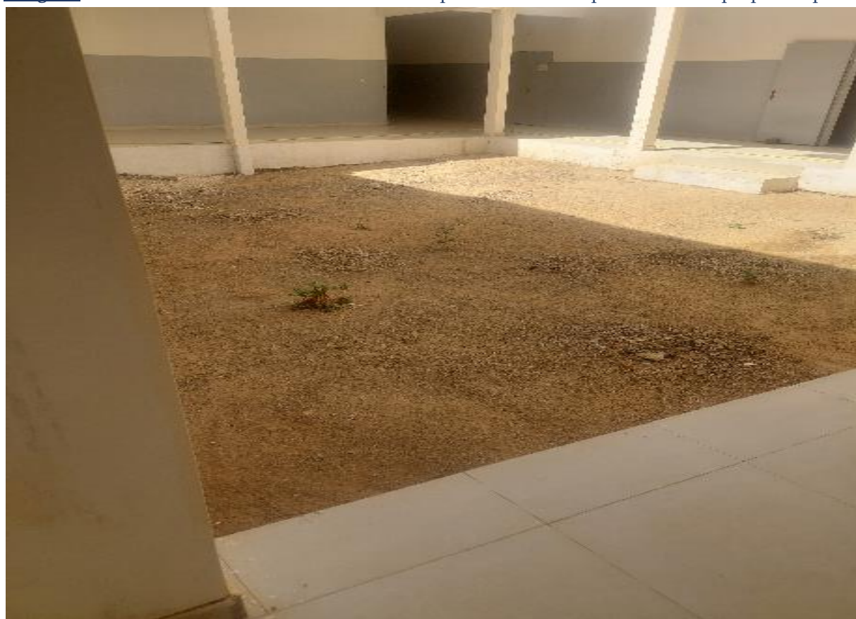
Image 26 : Bâtiment 2 x 7 : Non-conformité entre les plans archis et les plans réalisés à propos du patio
