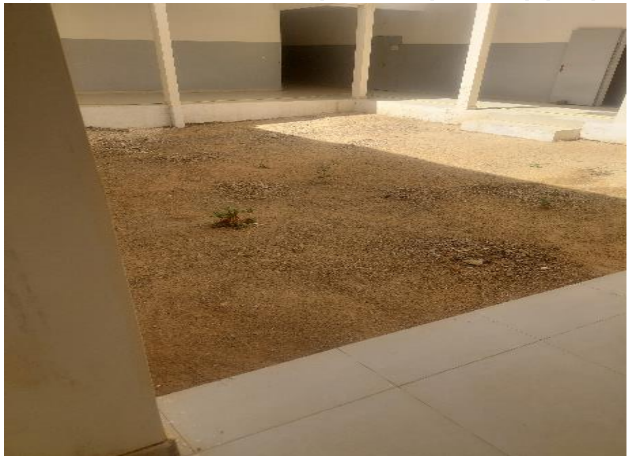
Image 15 : Bâtiment 1 x 5 : Non-conformité entre les plans archis et les plans réalisés à propos du patio
