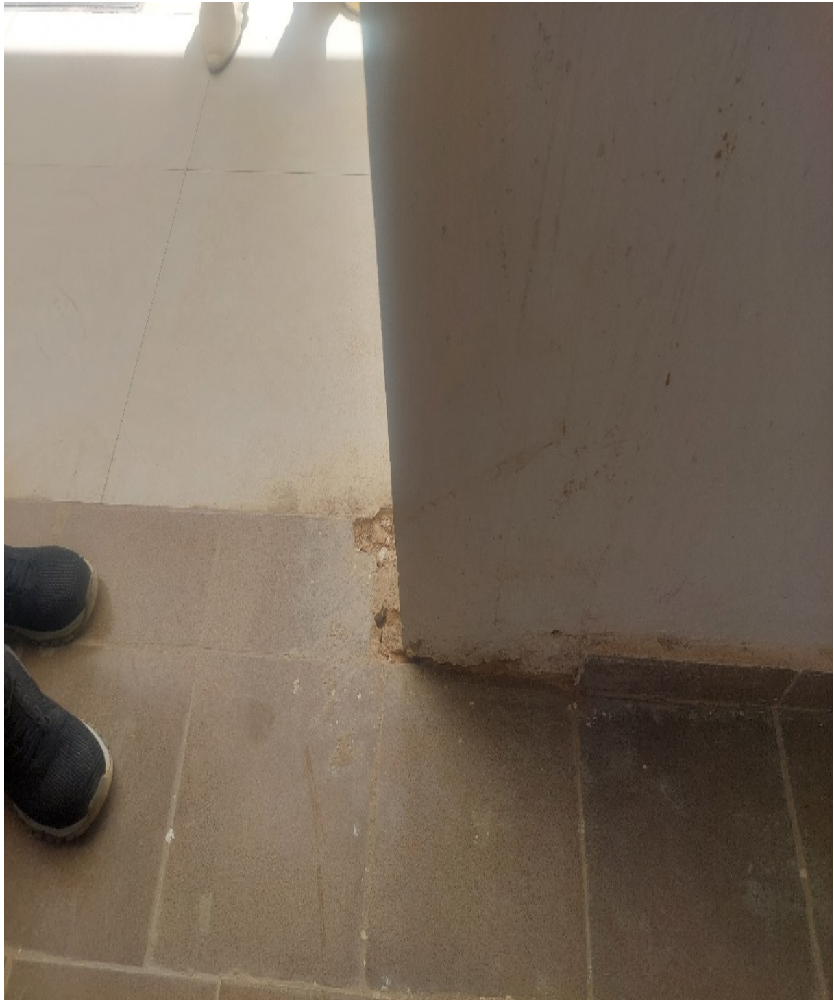
Image 18 : Bâtiment 2 x 7 : Absence de plinthes par endroit
