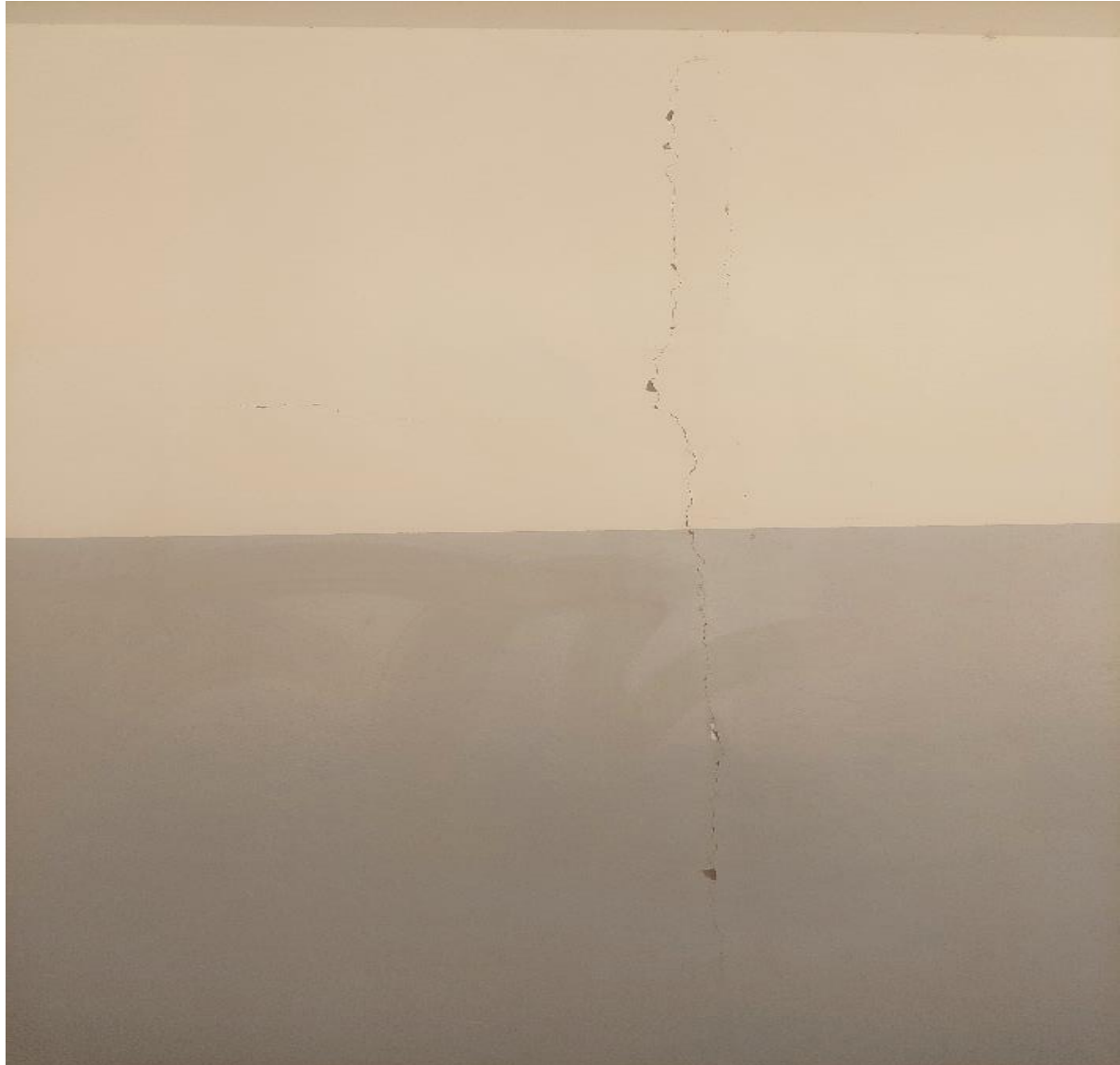
Image 17 : Bâtiment 2 x 7 : Fissures sur les murs et les planchers
