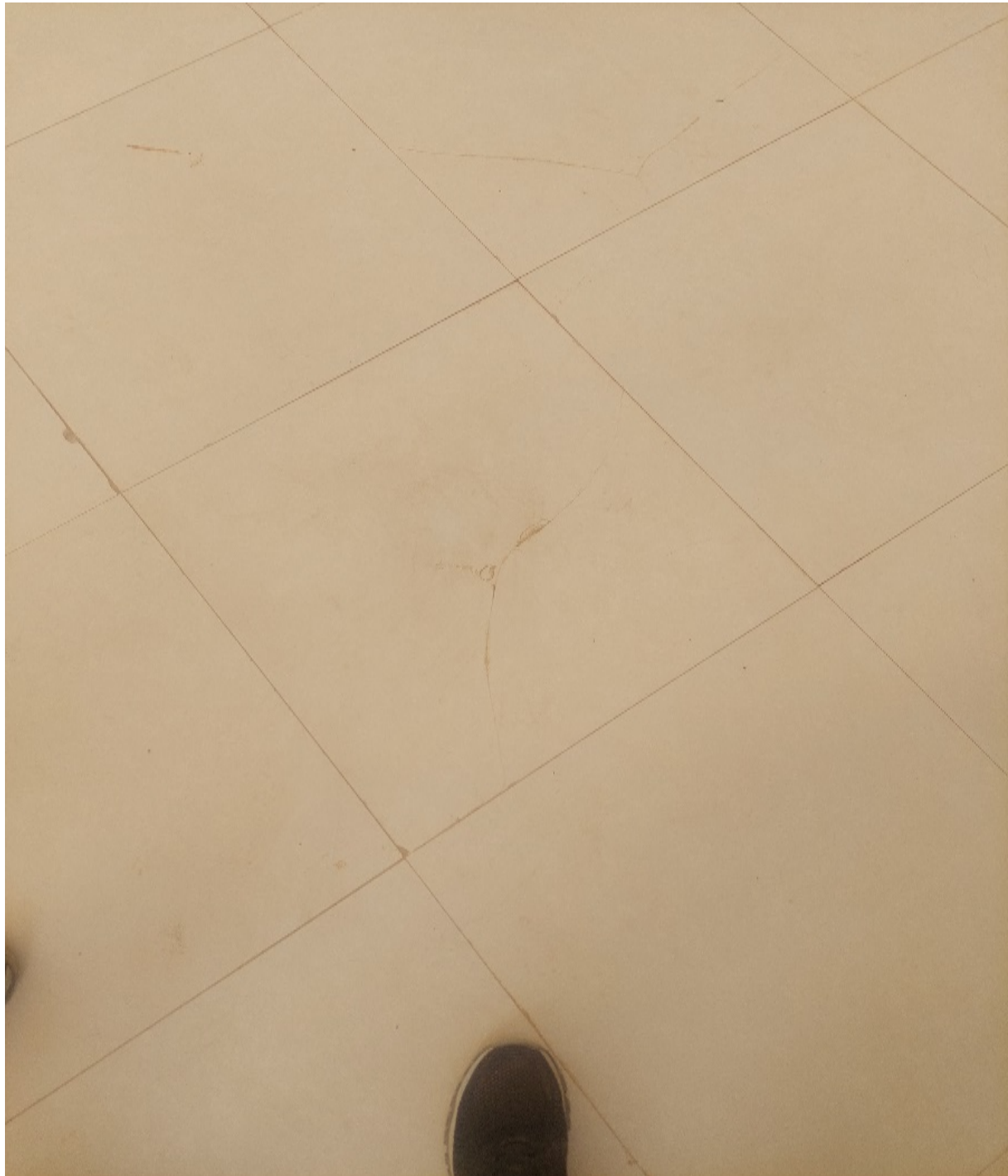
Image 19 : Bâtiment 2 x 7 : Cassure de carreaux
