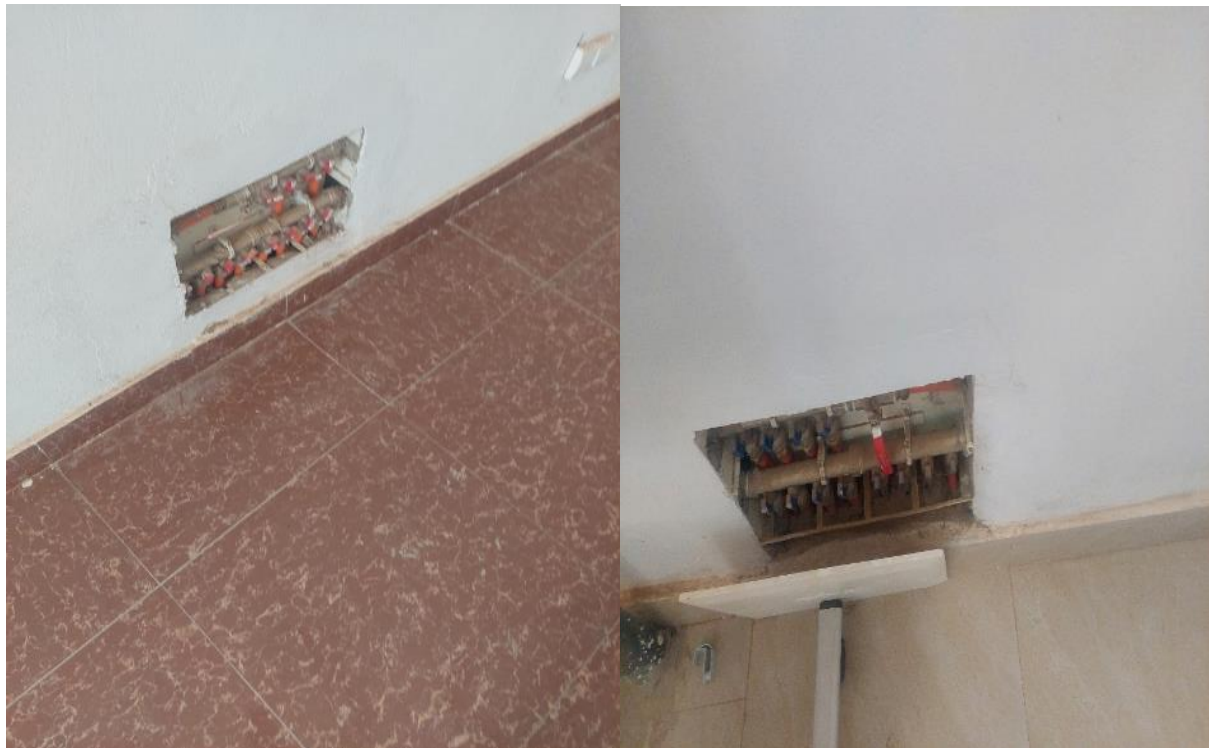
Image 28 : Bâtiment 2 x 7 : Absence de couverture des nourrice de plomberie
