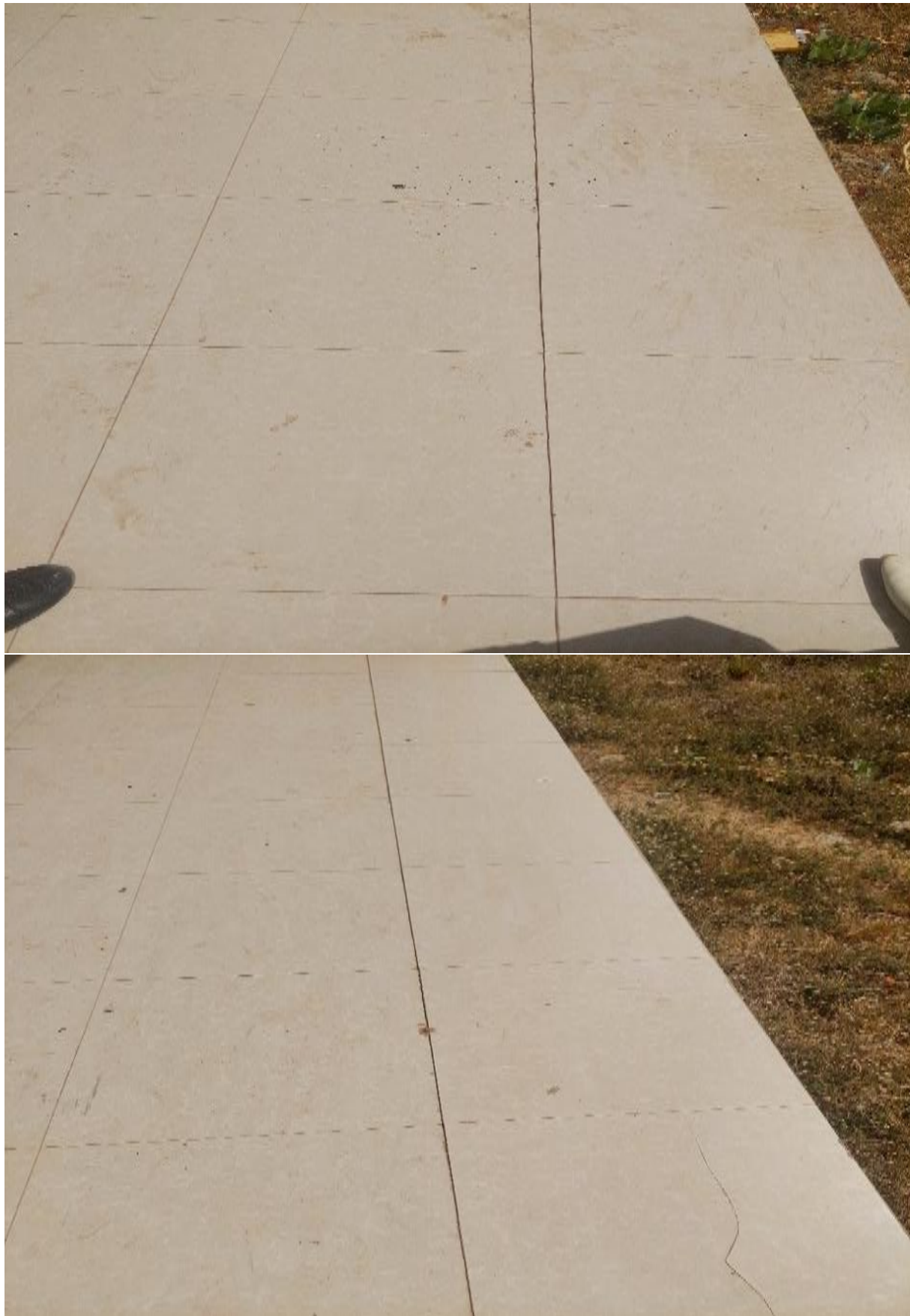
Image 6 : Bâtiment 1 x 5 : Affaissement de sol bâtiment
