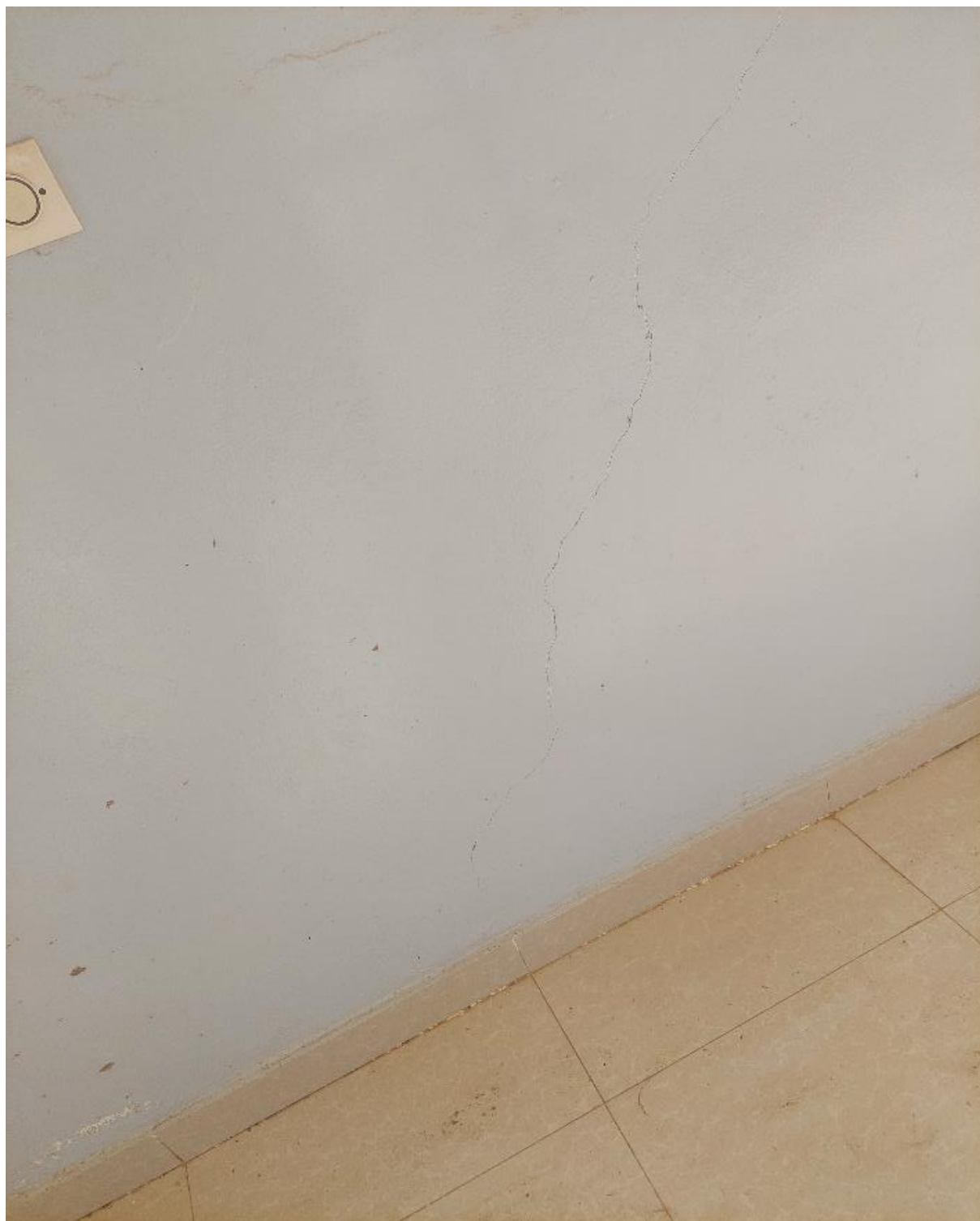
Image 23 : Bâtiment 2 x 7 : Insuffisance de la couche de peinture au niveau de certaines salles
