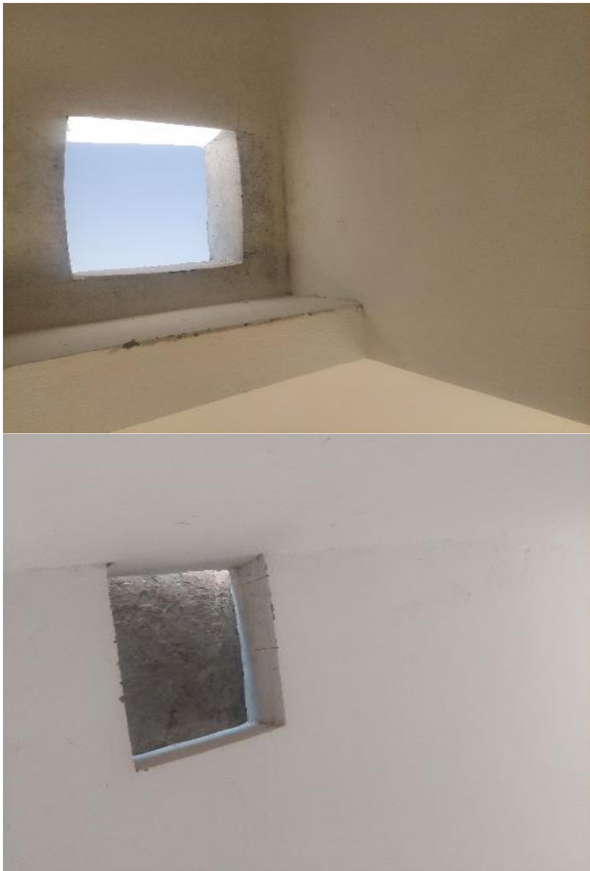
Image 20 : Bâtiment 2 x 7 : Faiblesse de la taille et non couverture de certaines trappes
