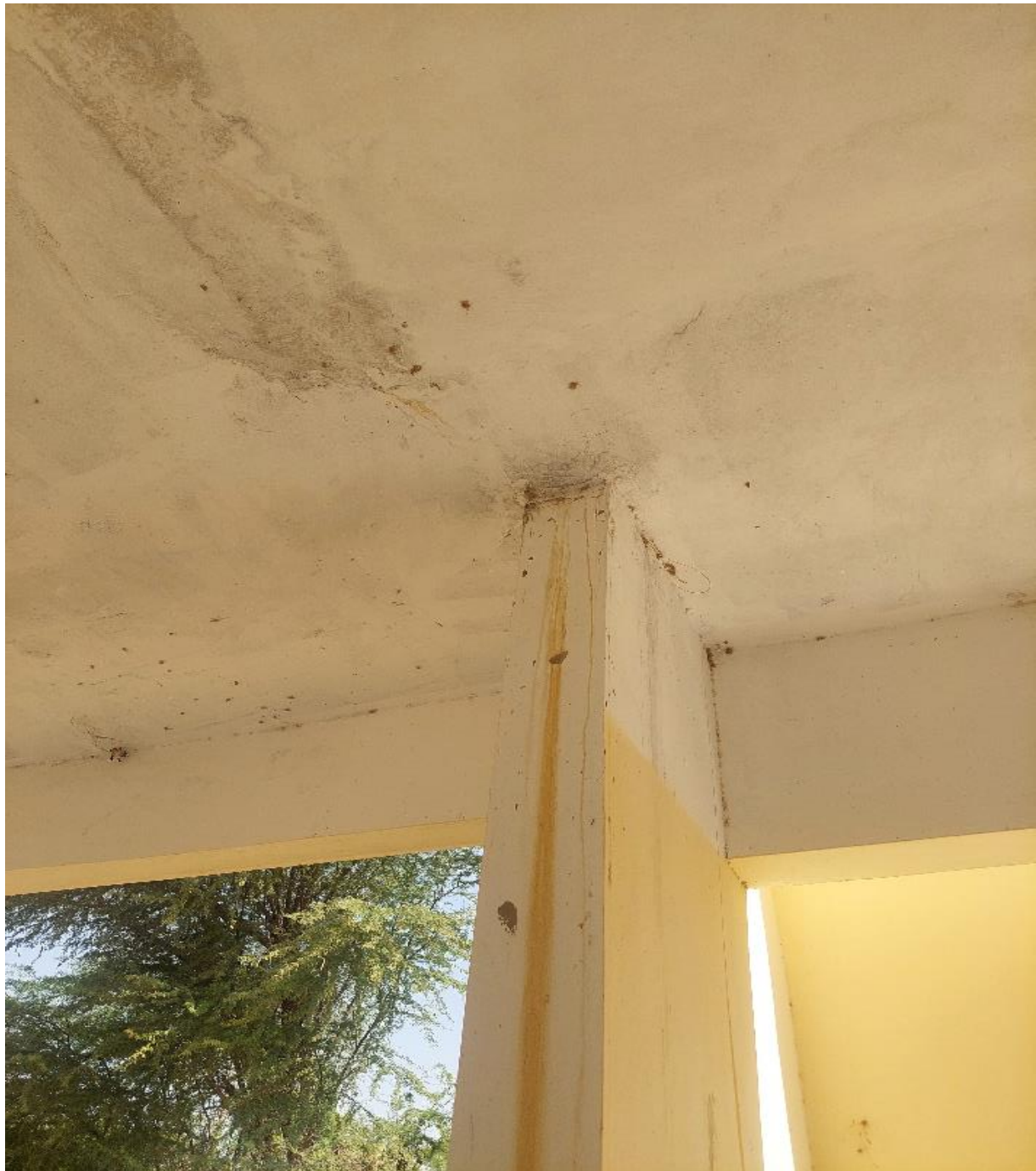
Image 24 : Bâtiment 2 x 7 : Traces d'eau au niveau des sous planchers
