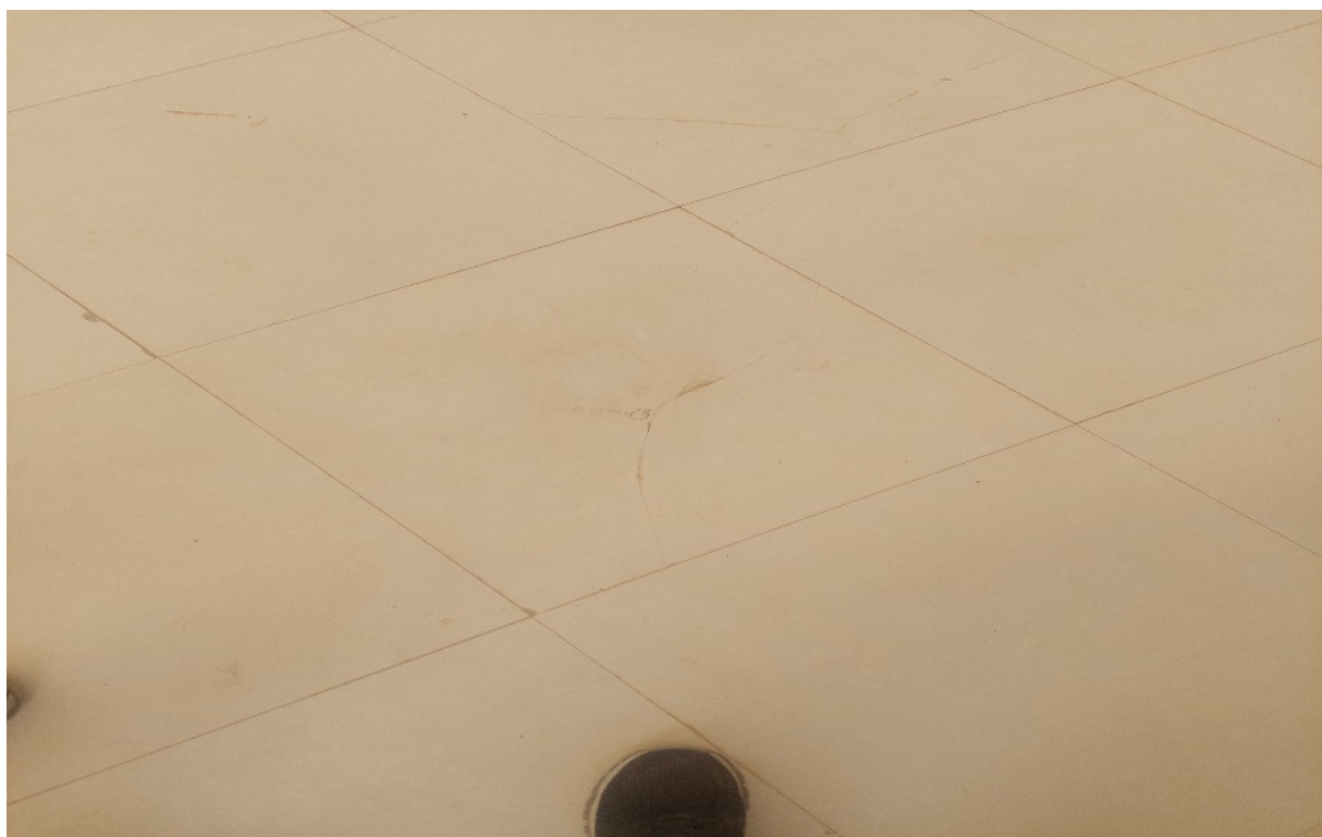
Image 29 : Bâtiment 2 x 7 : Cassure de carreaux
