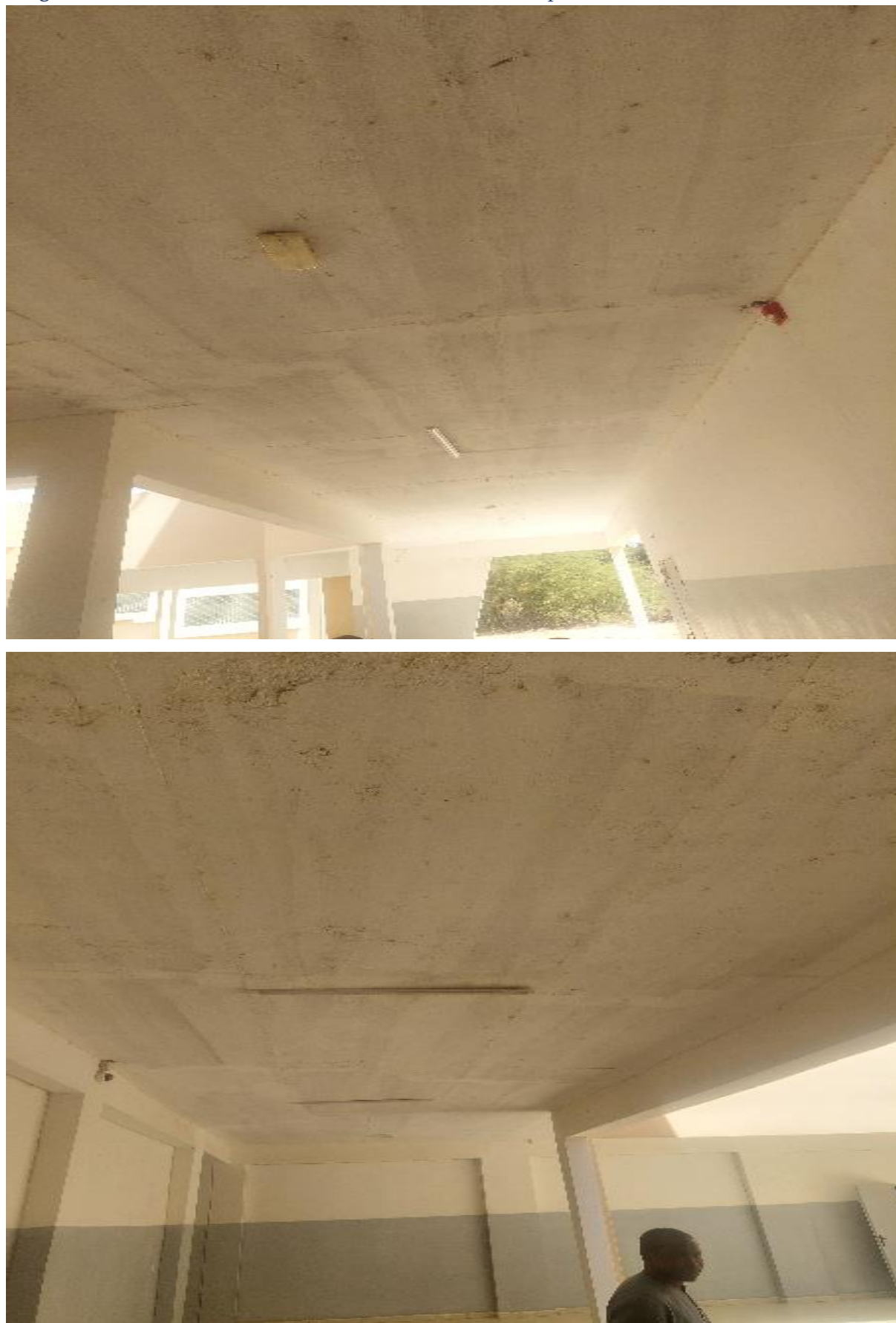
Image 10 : Bâtiment 1 x 5 : Insuffisance de la couche de peinture au niveau de certaines salles
