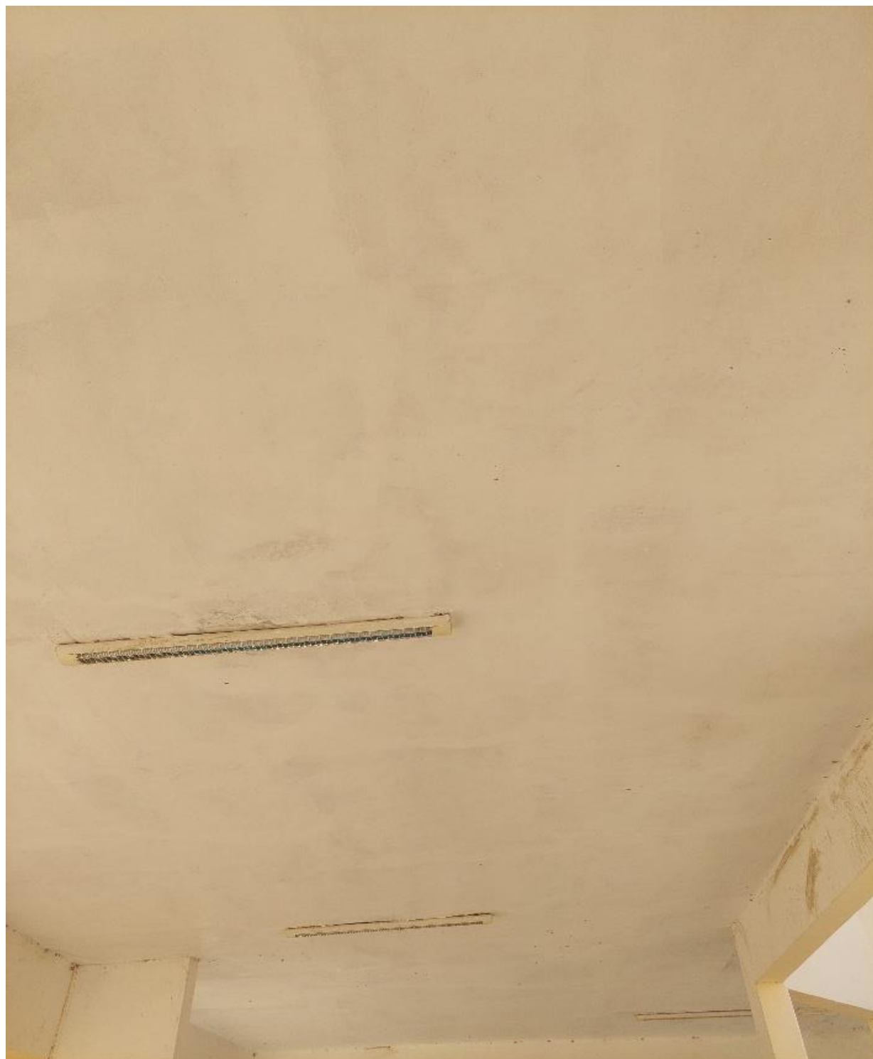
Image 22 : Bâtiment 2 x 7 : Insuffisance de la couche de peinture au niveau des halls du bâtiment
