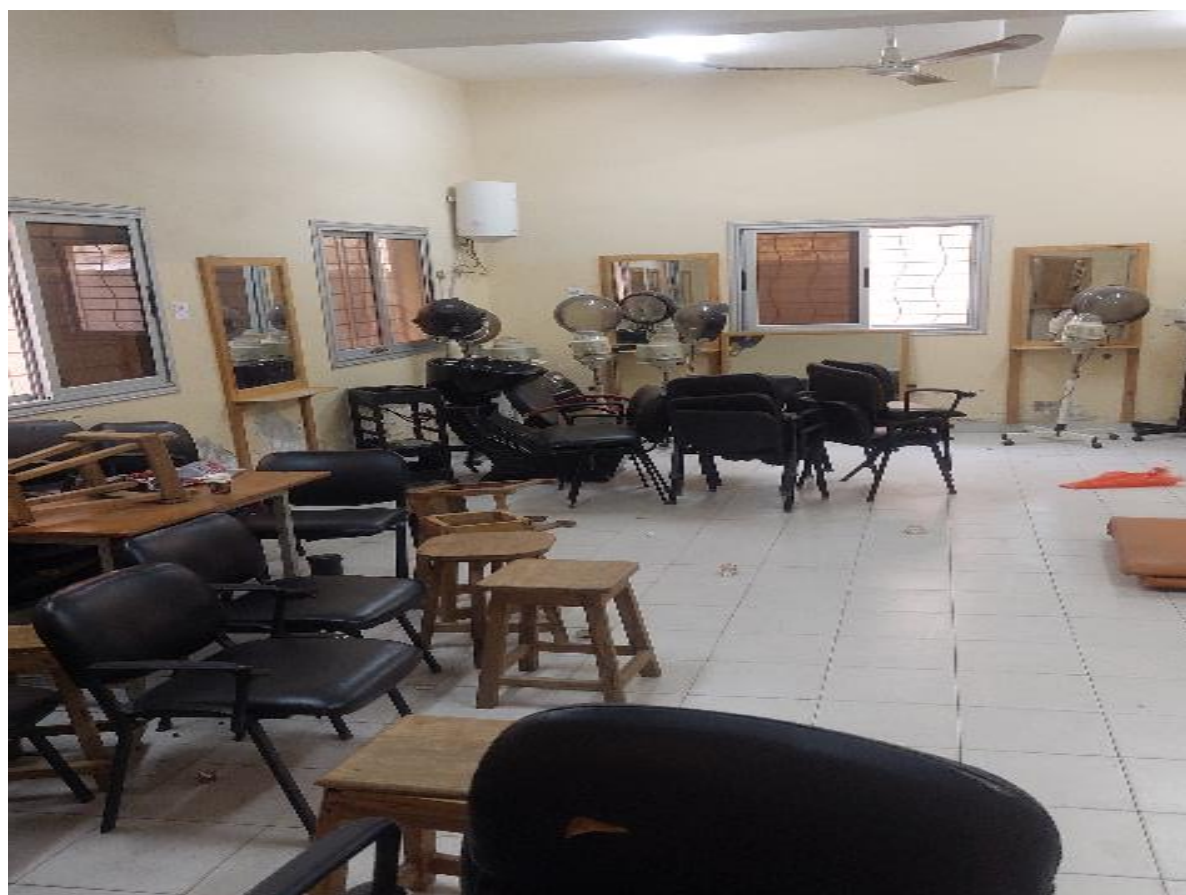
Image 5 : Non réalisation de certains murs de cloisonnement
