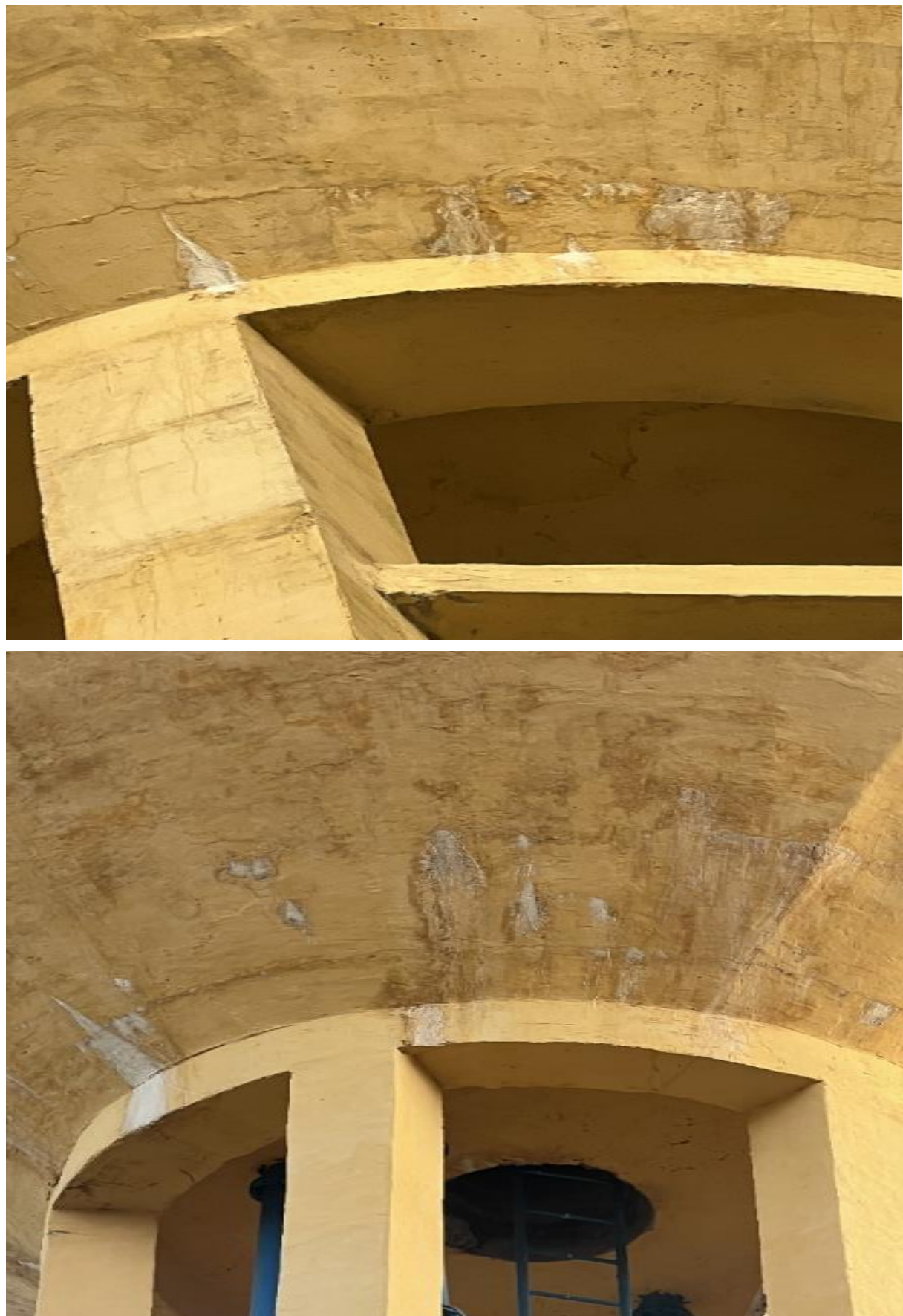
Image 4 : Traces d'humidité sur les cuves des châteaux d'eau
