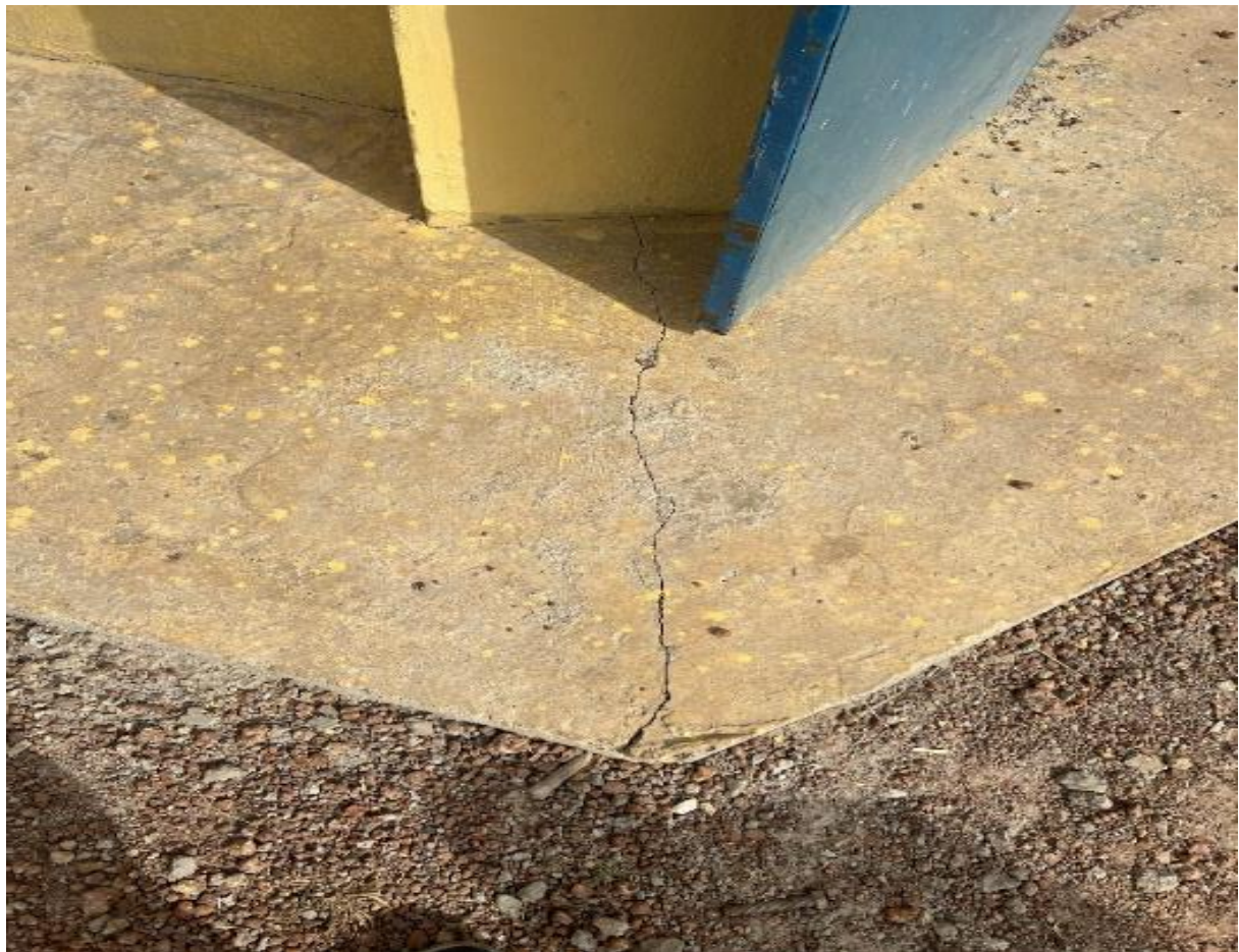
Image 1 : Apparition de fissures au niveau de la chambre vanne et dalle anti bourbier
