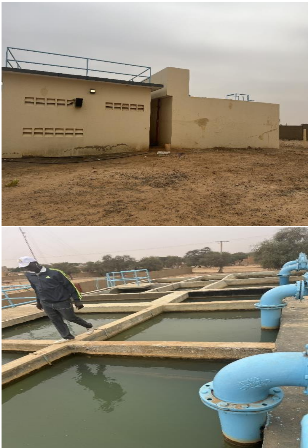
Image 1 : Apparition de fissures au niveau des bassins de rétention
