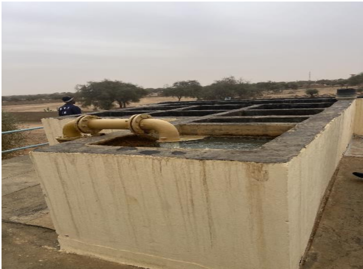
Image 3 : Traces d'humidité sur la dalle du bassin de traitement
