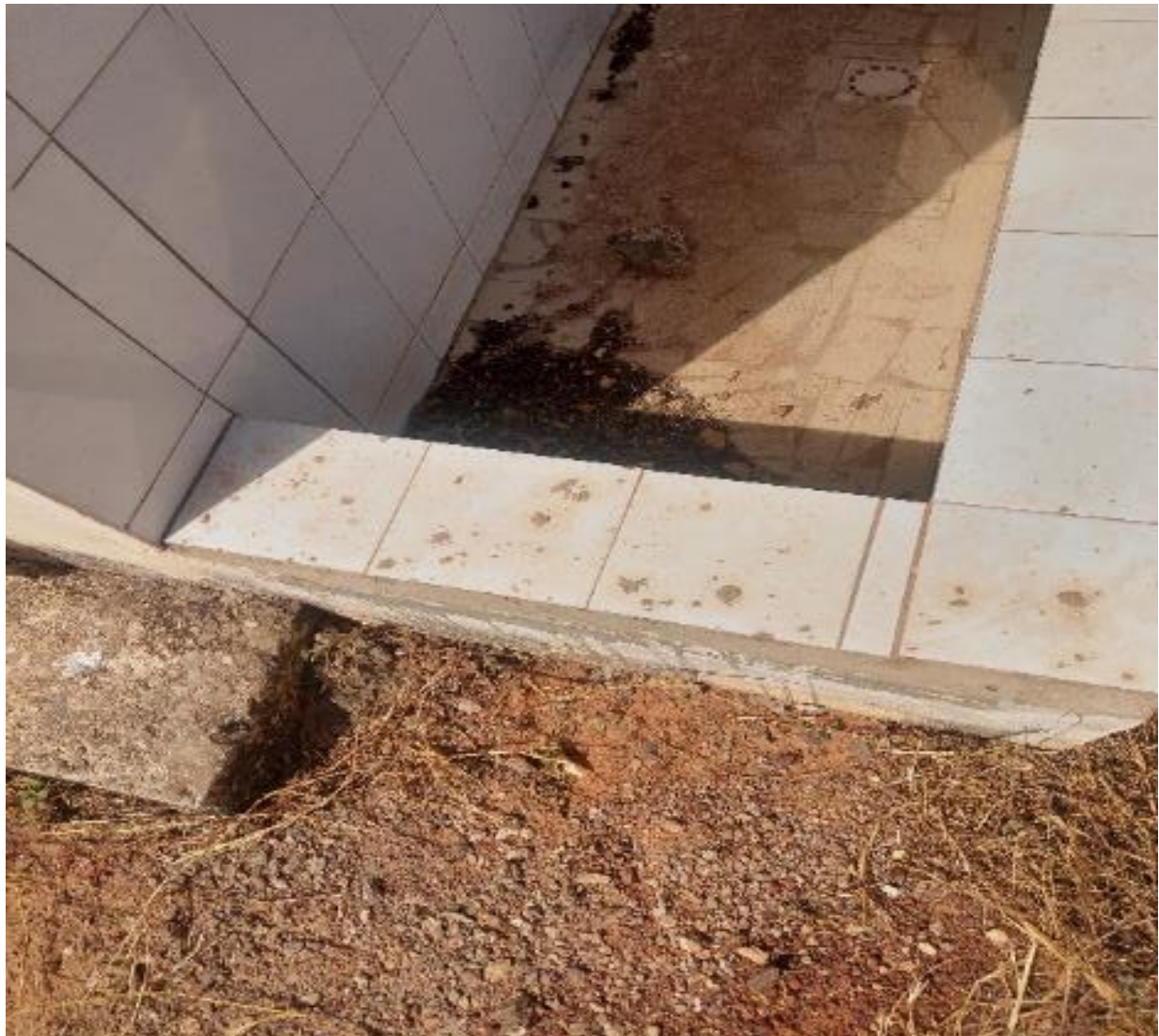
Image 5 : Mauvaise forme de la pente des siphons de sol
