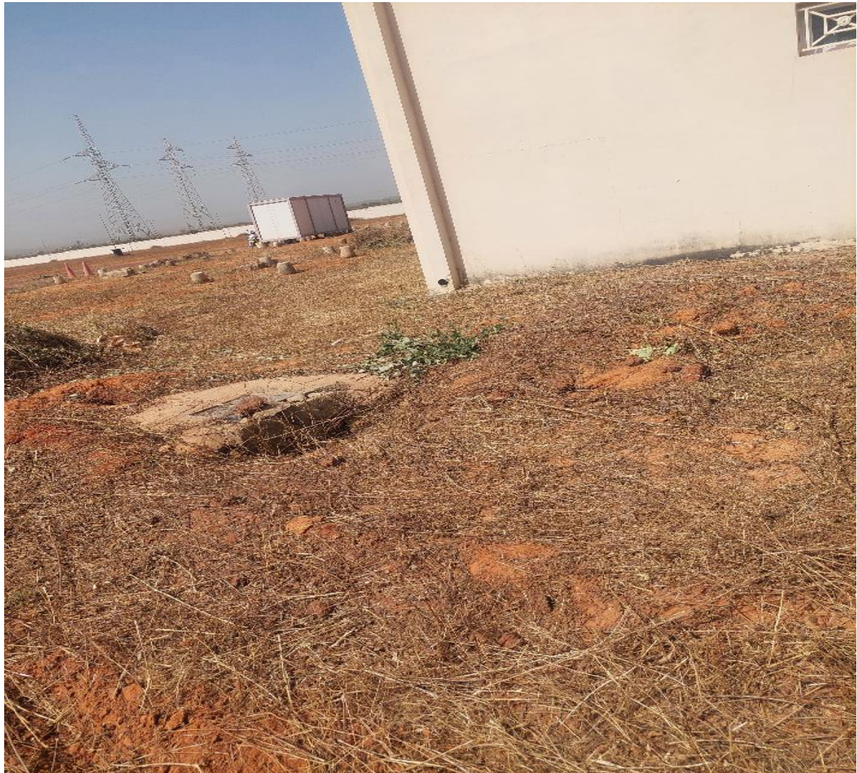
Image 9 : Puits perdu trop proche du bâtiment
