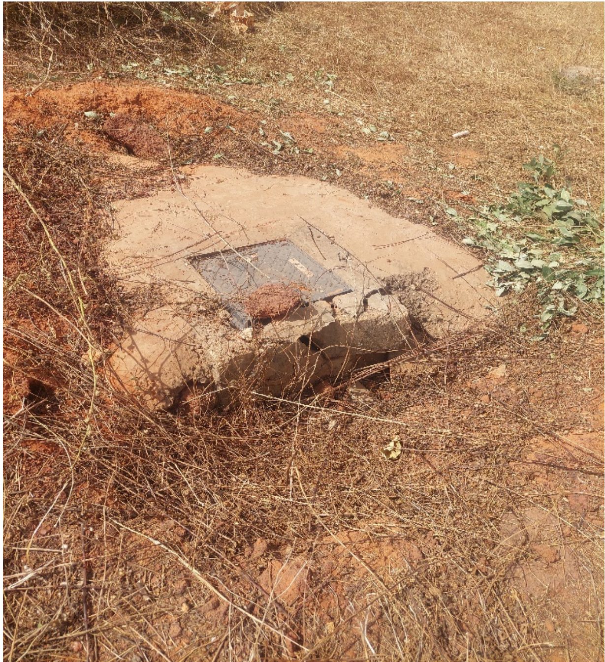
Image 6 : Non-conformité de la fosse septique
