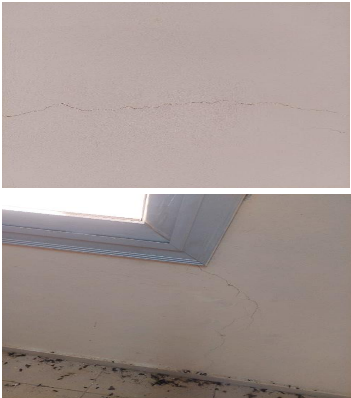
Image 3 : Fissures sur les murs intérieur et extérieur
