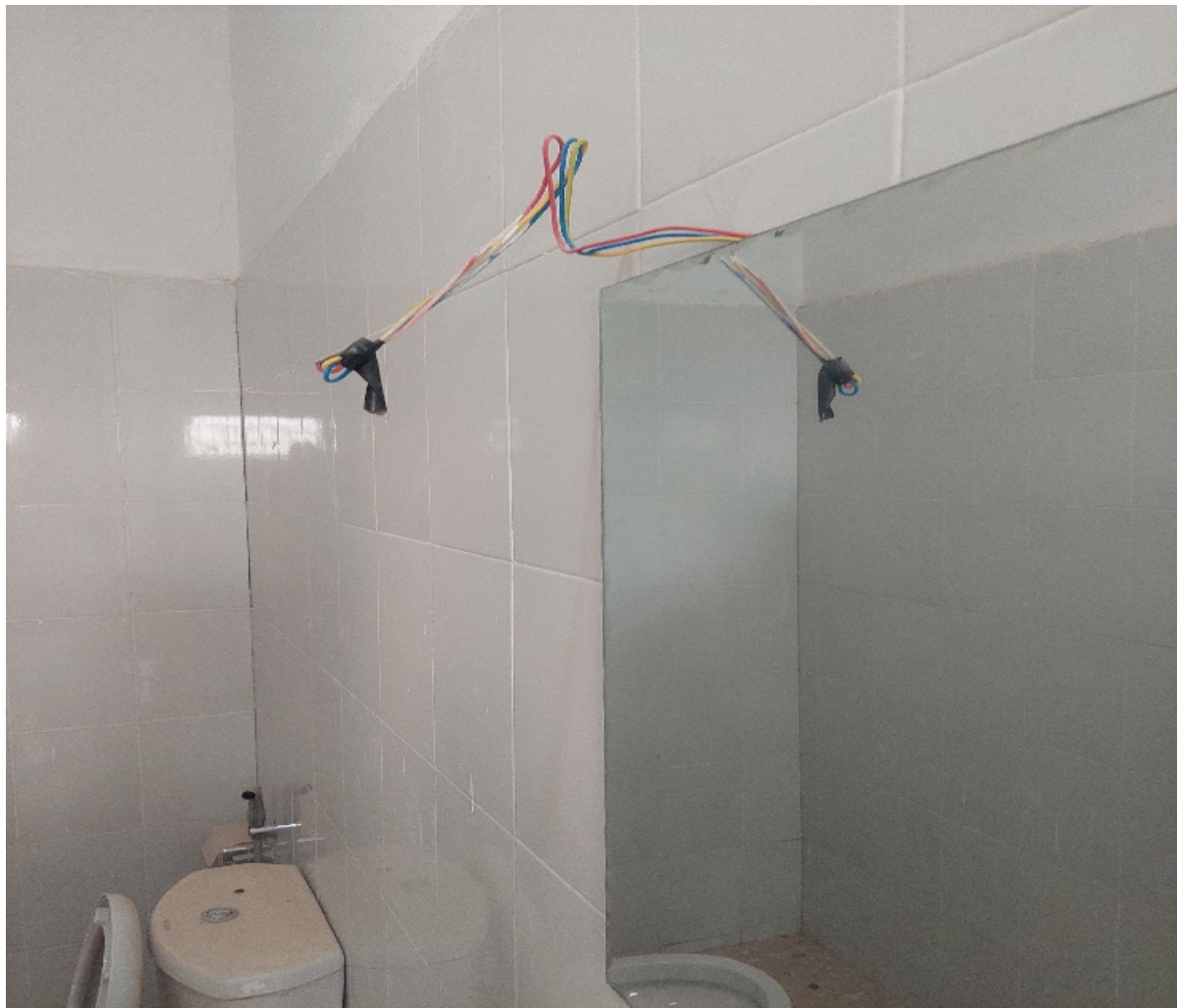
Image 8 : Absence de la linolite au niveau de la toilette intérieure
