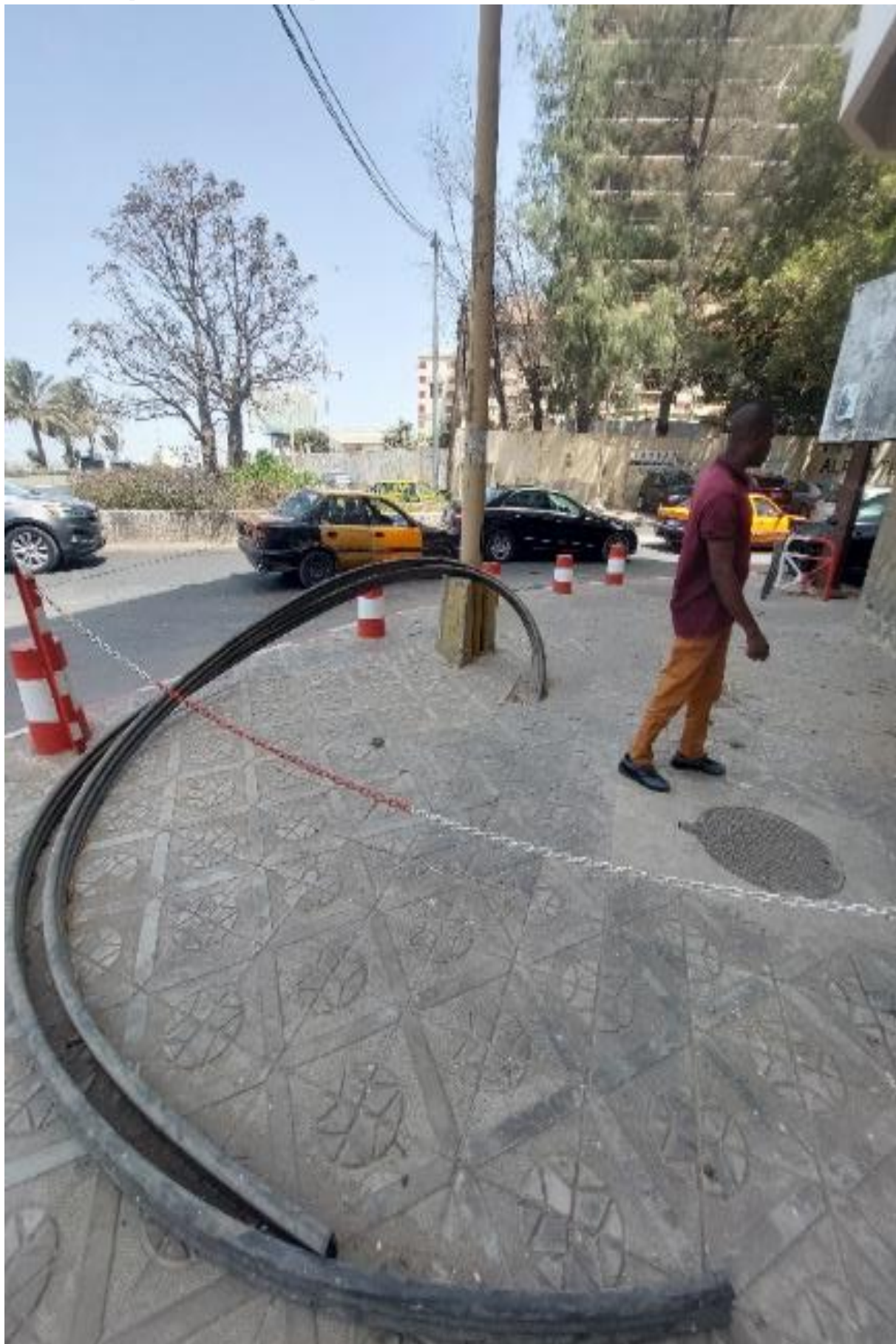
Image 1 : Non-réalisation des traversées de voies et présence d'attentes câbles non conventionnelles sur les sites du Cap-manuel et du Camp-Leclerc
