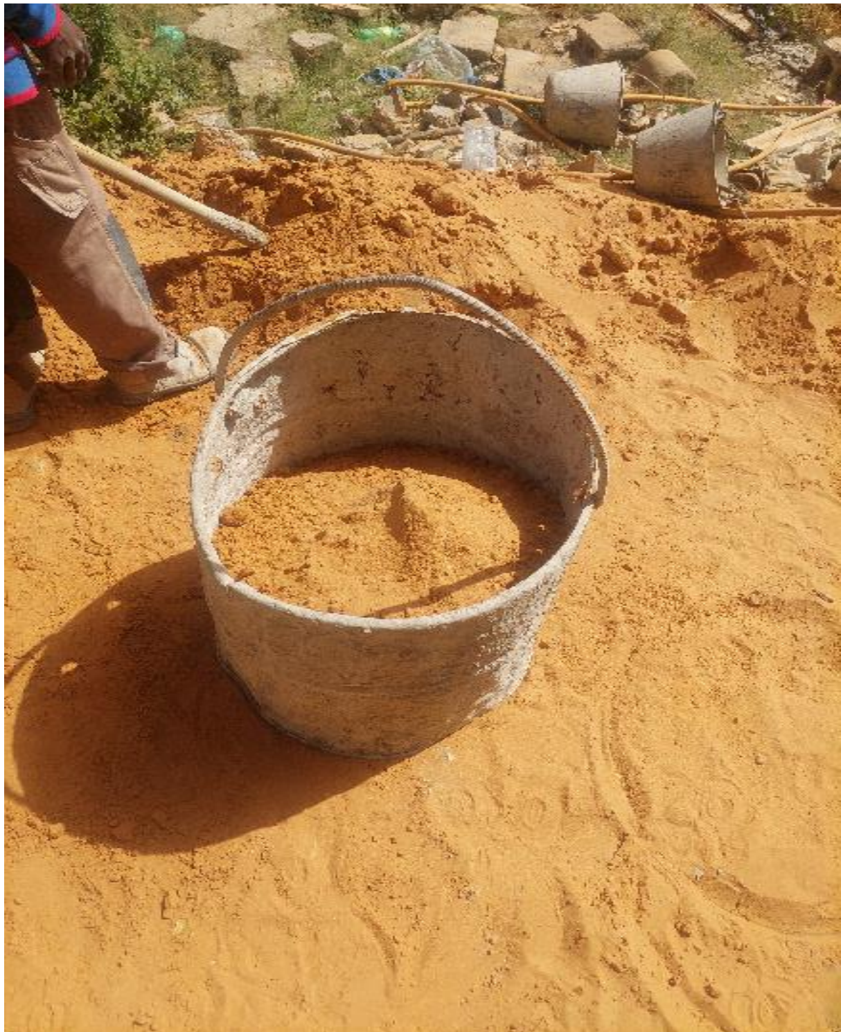
Image 3 : Utilisation d'un sable de qualité non satisfaisante
