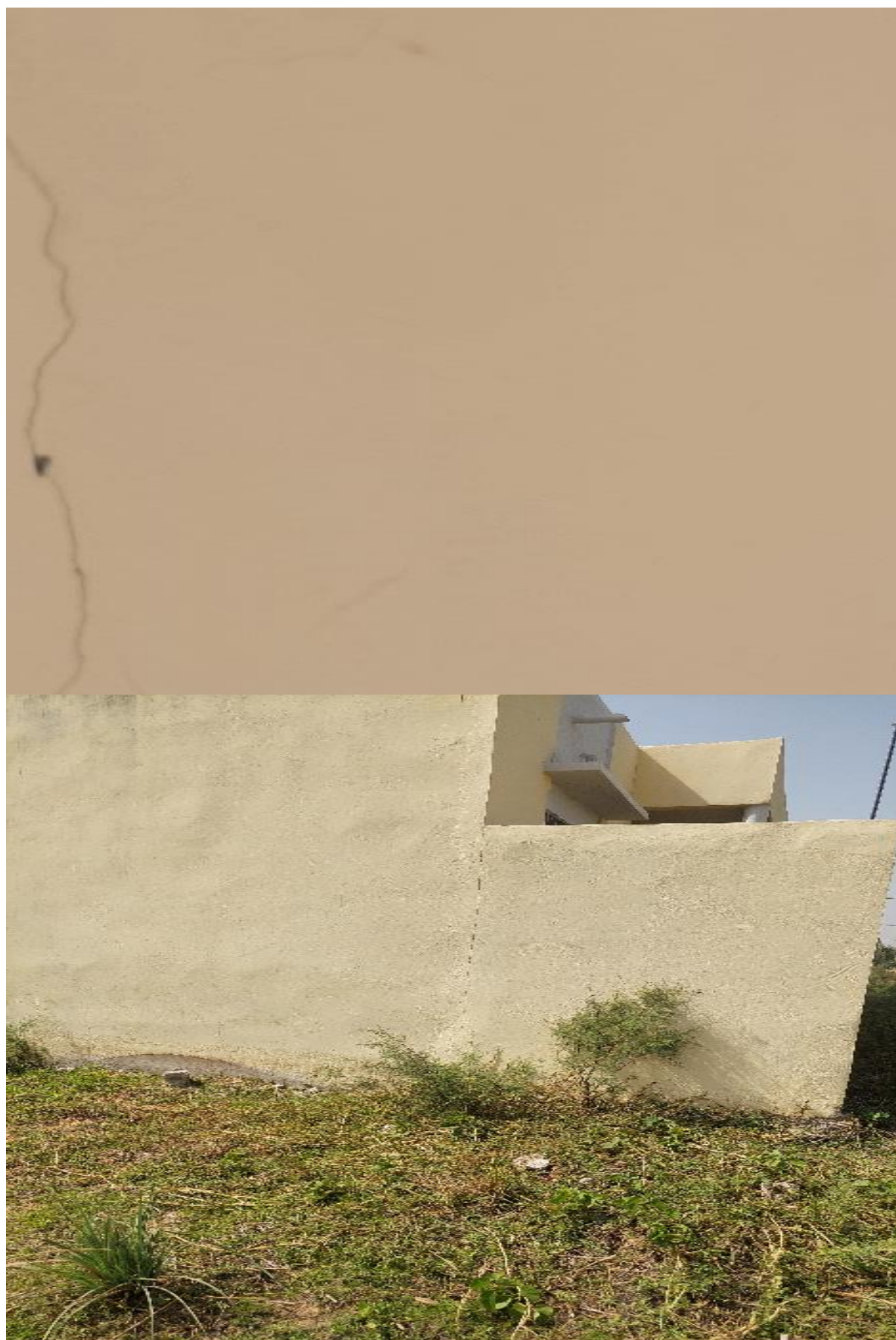
Image 3 : Apparition de fissures sur les murs
