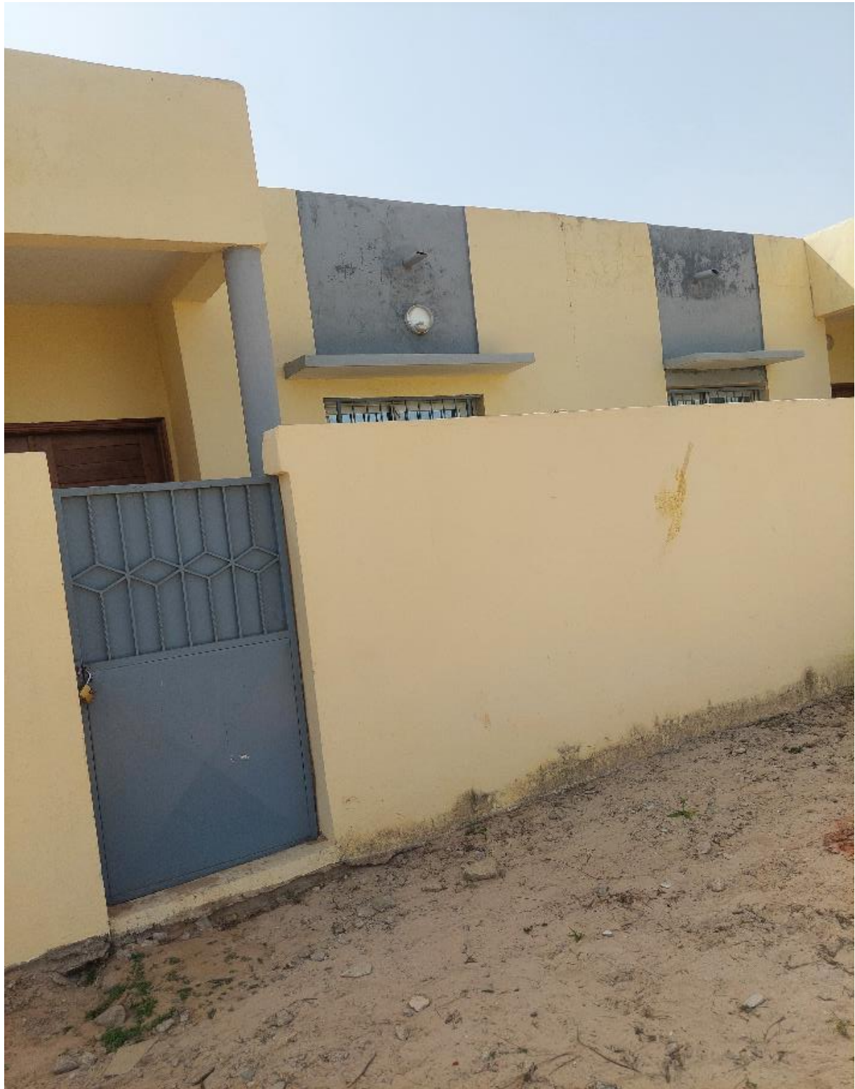
Image 7 : Apparition de traces d'eau sur les murs et sous-auvents
