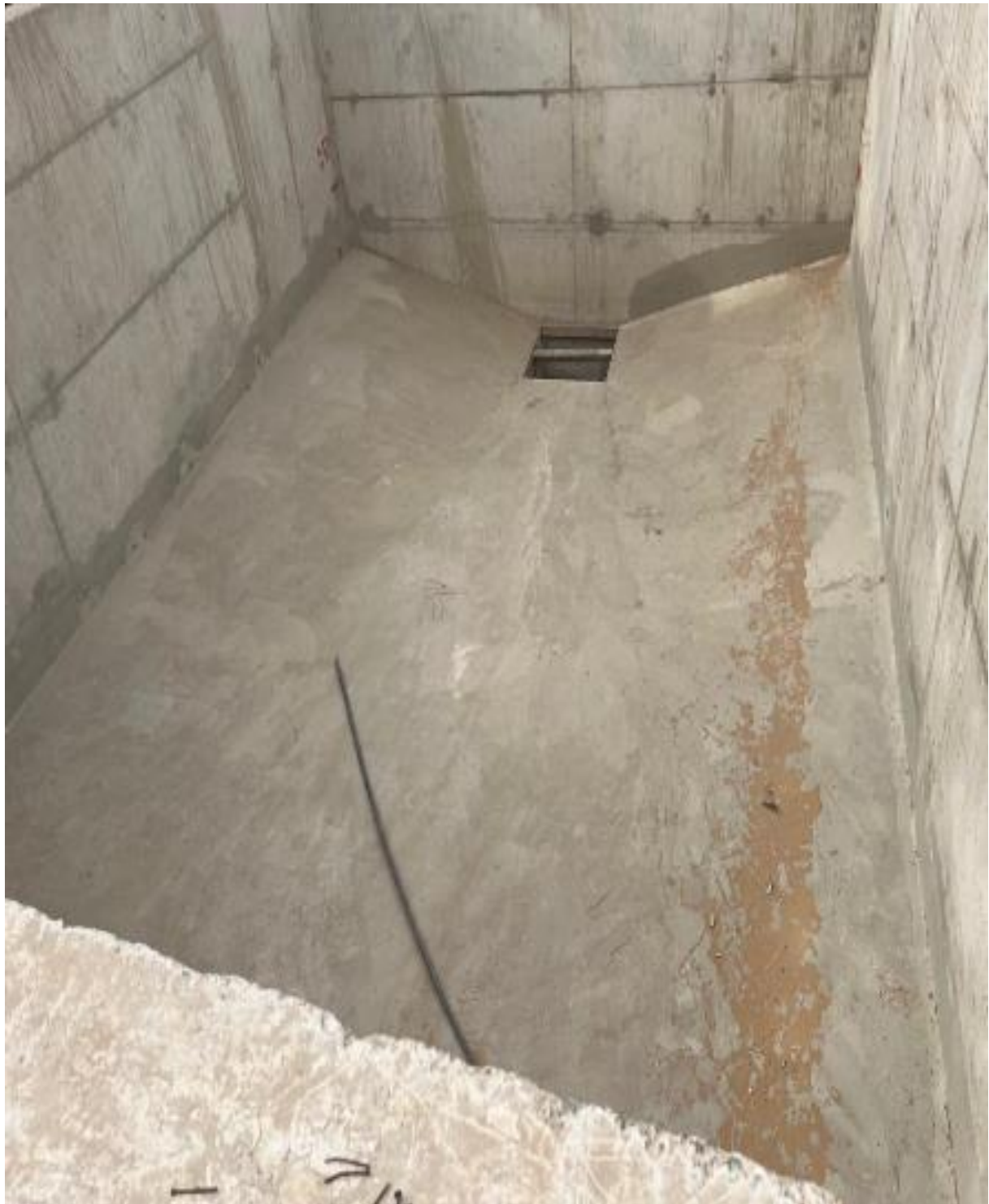
Image 2 : Non-pose des équipements de la bêche au niveau de la prise d'eau à Bango
