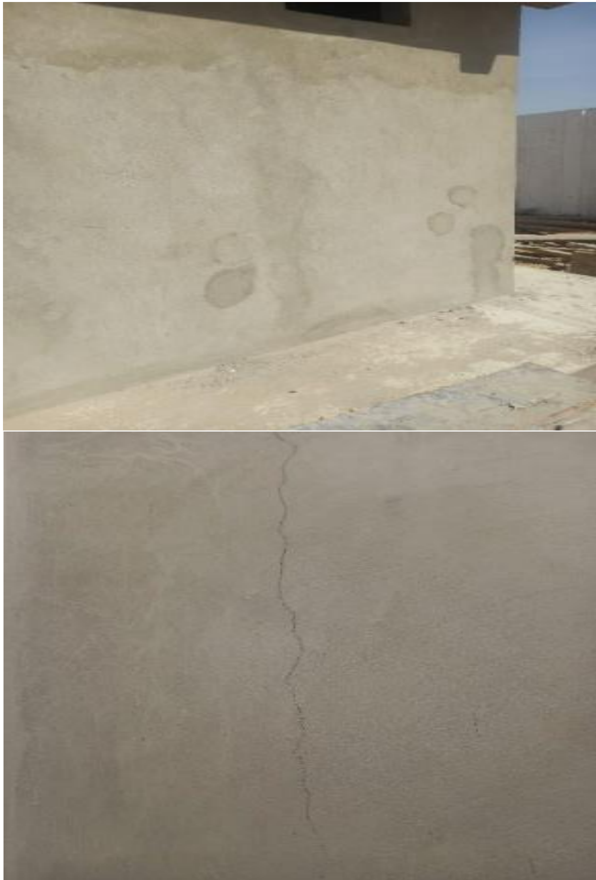
Image 2 : Apparition de fissures sur le mur du logement du gardien
