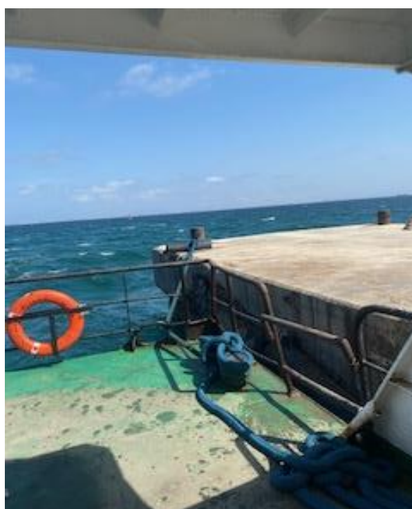
Dégradation sur le côté du quai
