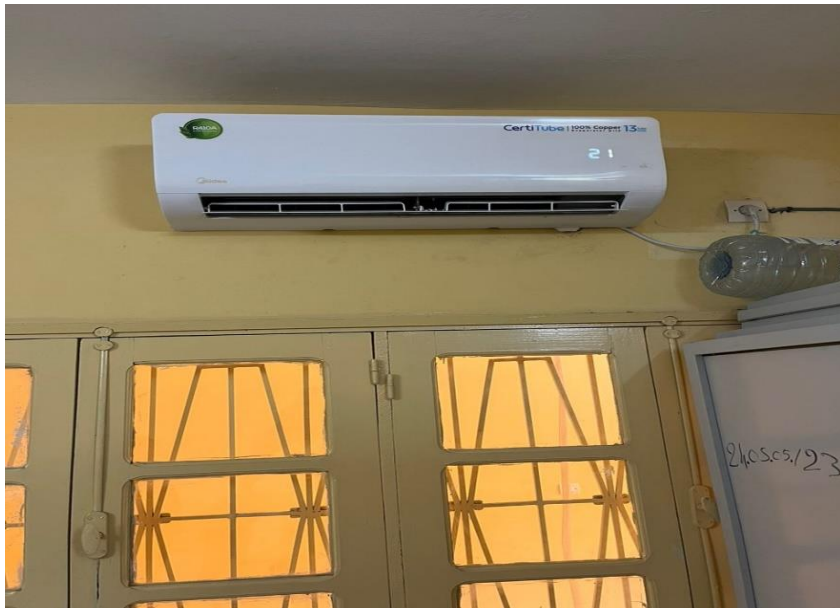
Climatiseur installé dans les bureaux
