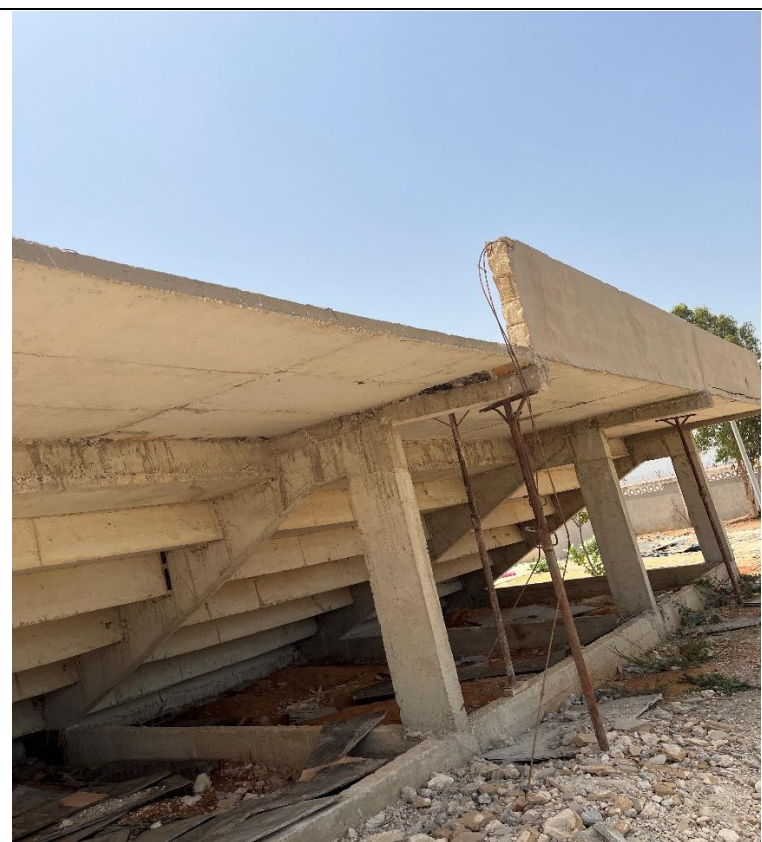
Support métallique intégré destiné à soutenir la tribune
