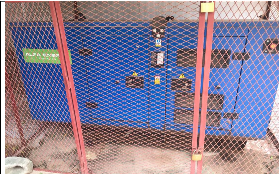
La mission a constaté que le Groupe électrogène est bien livré à l'antenne Sud PZTA
