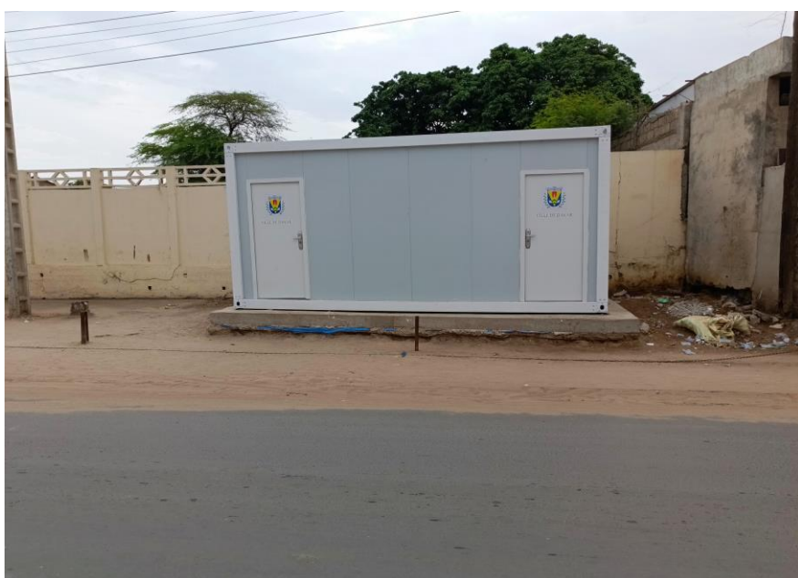
Certaines toilettes ne possèdent pas les rampes pour faciliter l'entrée des personnes à mobilité réduite, ce qui est contraire aux spécifications mentionnées dans le DAO.
