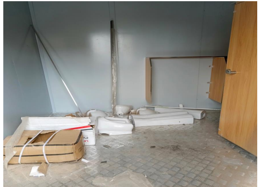
la mission a constaté que toutes les toilettes ne sont pas opérationnelles
