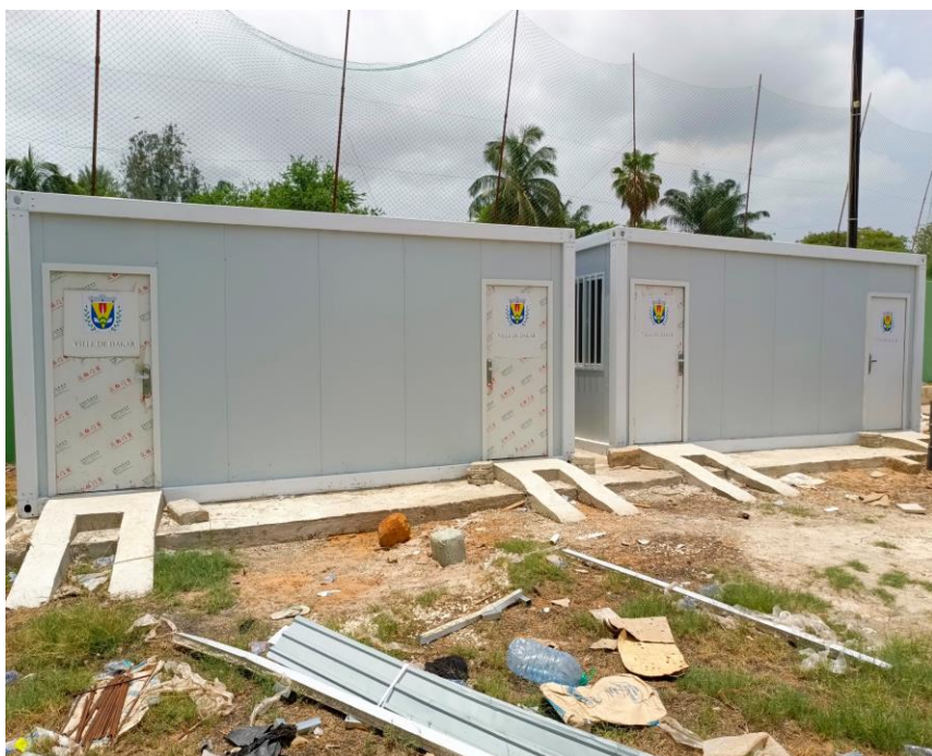
La mission a constaté que certaines toilettes publiques préfabriquées sont installées dans des endroits inappropriés et difficiles d'accès à savoir des terrains de football à usage privé à la Medina ou deux toilettes ont été installées et une autre toilette également installée à l'arrière-cour du commissariat des parcelles assainies de l'unité 15.
