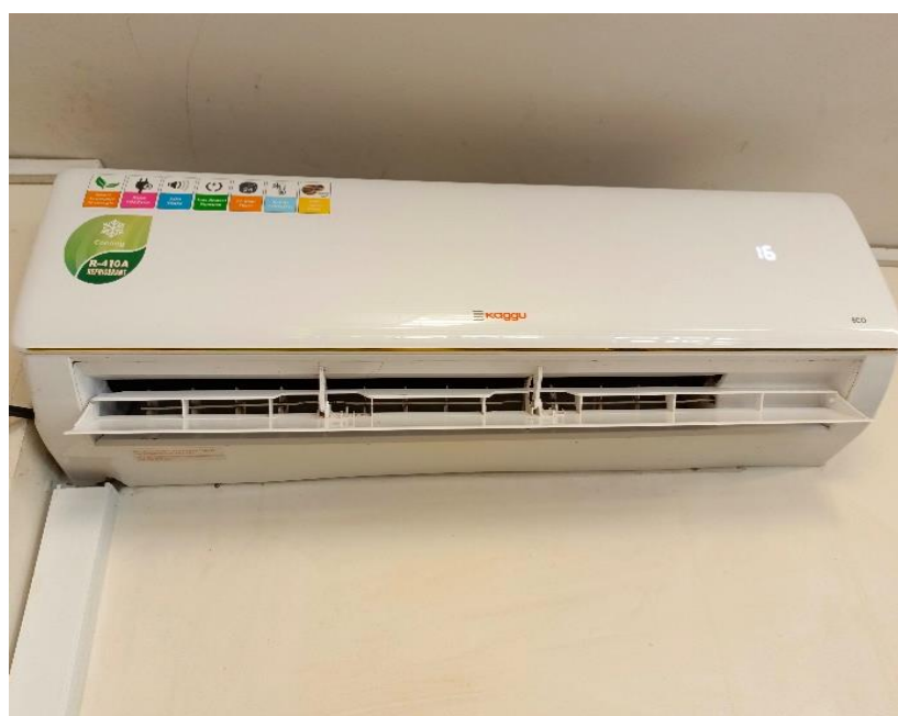
Fourniture d'appareils de climatisation.
