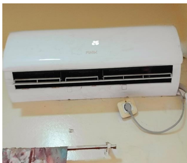
Fourniture d'appareils de climatisation.
